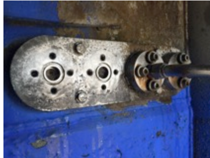
Ilustración 110: Juntas pasa-mamparos Fuente: Trabajo de campo
