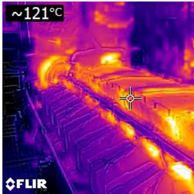
Ilustración 16: MP (cámara térmica) Fuente: Archivo fotográfico del barco
