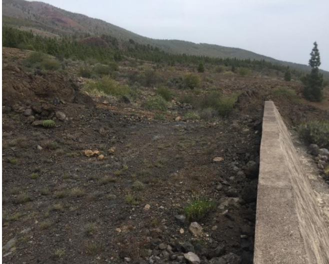
Figura 11. Muro sobre la colada y rotura del levée lateral para la canalización de la escorrentía hacia la balsa de Chifira.
