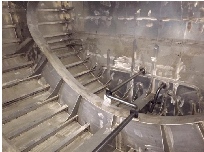
Tanque de combustible de babor
