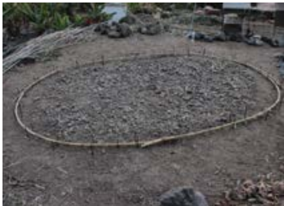
Planta de la estructura, modelando la base con un óvalo de 6 x 5 m con las estacas que guían la caña.
