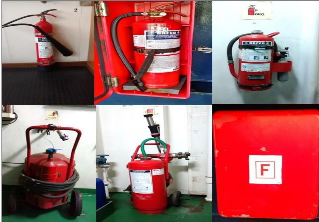
Extintores vários. Fuente : Elaboración propia
