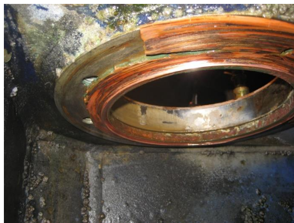
Fig. 65. Elemento de desgaste dañado
