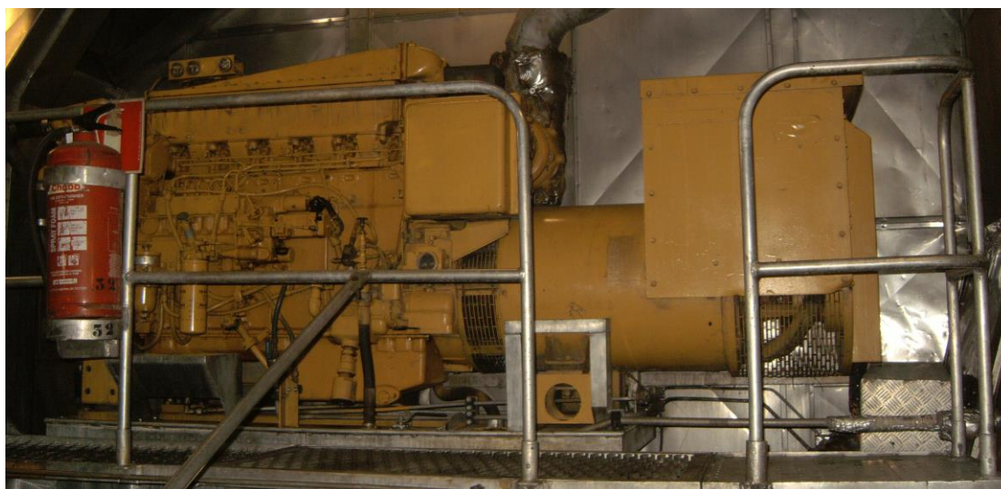
Fig. 21. Vista del Motor Auxiliar 1
