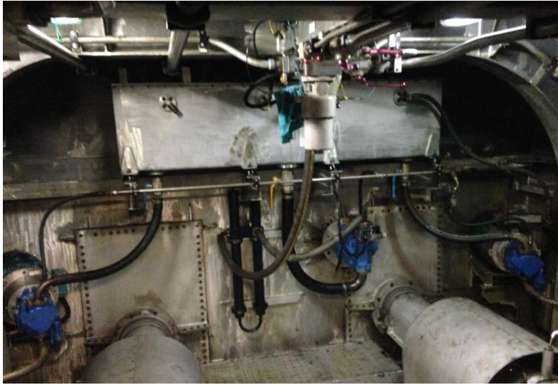
Fig. 42. Vista de la Sala de Jets. Bomba PTO y bombas eléctricas
