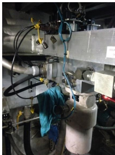
Fig. 49. Colector con presostatos y filtro diferencial
