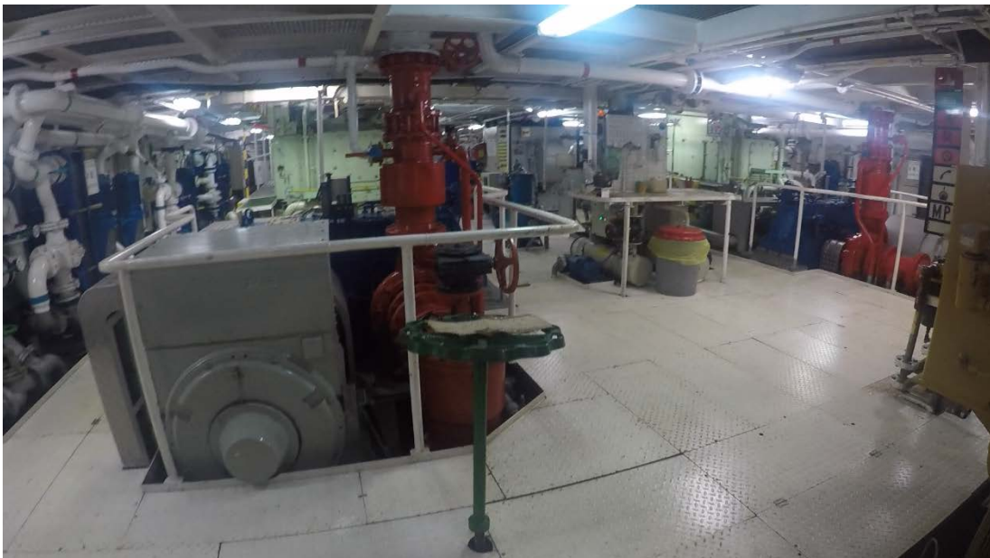
43 Toma de agua de mar de la bomba FI-FI. Fuente: Trabajo de campo
