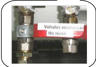
63 Válvulas de tanques Recoil
