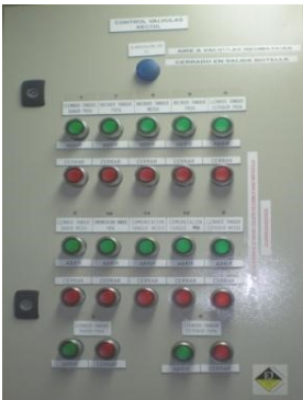
62 Panel de control tanques Recoil. Fuente: Trabajo de campo
