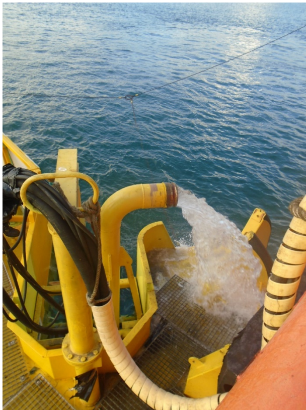
23 Caudal de aspiración de la bomba. Fuente: Trabajo de campo
