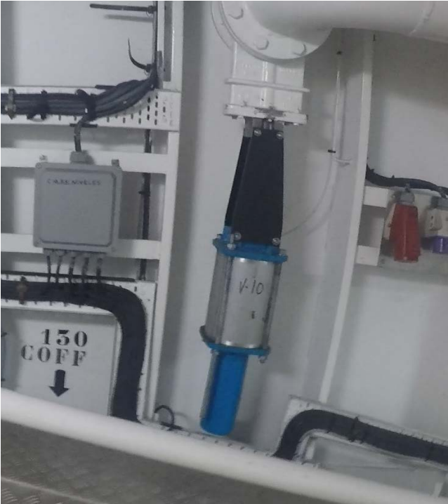
61 Válvula neumática tipo guillotina. Fuente: Trabajo de campo
