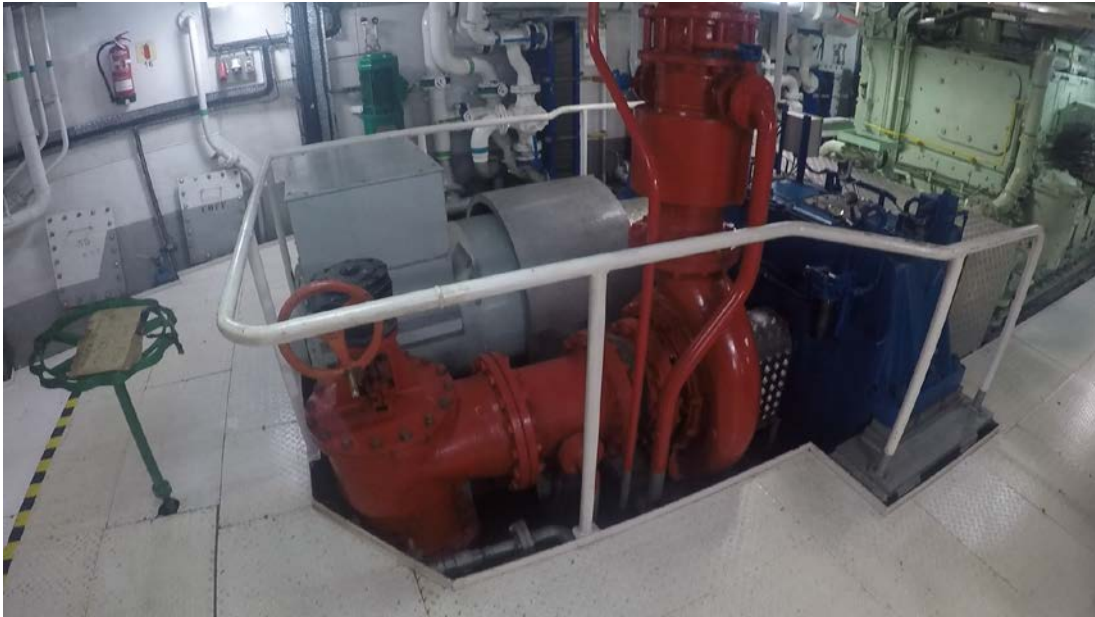
42 Bomba FI-FI. Fuente: Trabajo de campo
