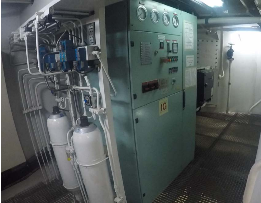
69 Planta de gas inerte. Fuente: Trabajo de campo
