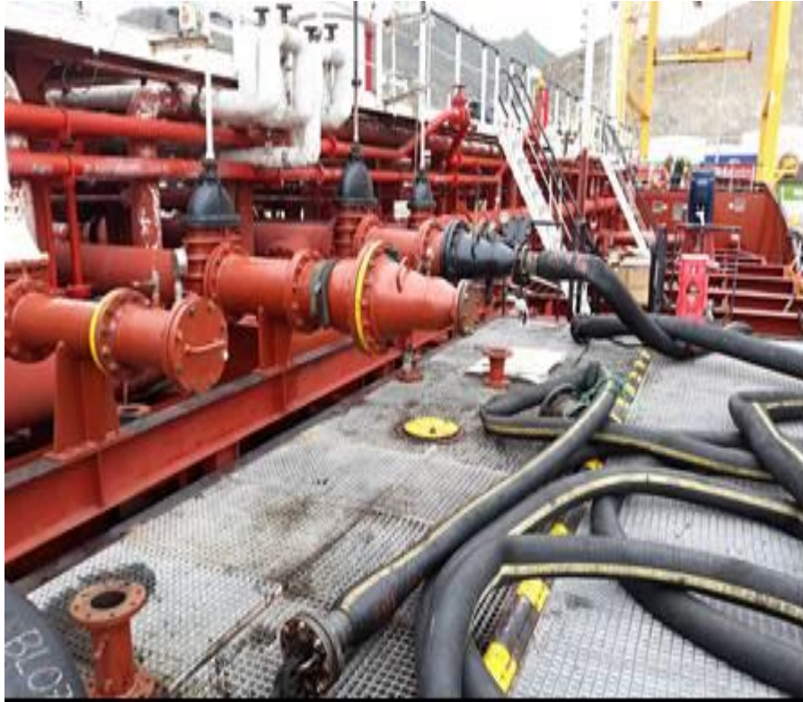
Ilustración 11: Mangueras de cubierta. Fuente: elaboración propia.
