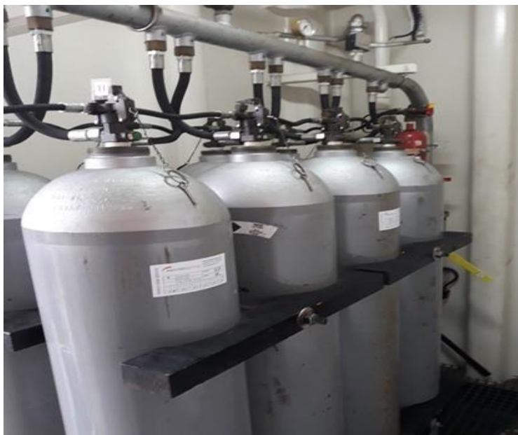
Ilustración 14: Cuarto de CO2. Fuente: elaboración propia.
