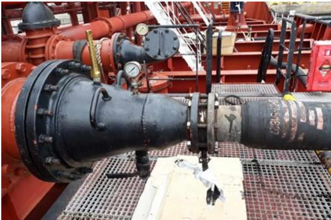
Ilustración 10: Manifold de carga. Fuente: elaboración propia.
