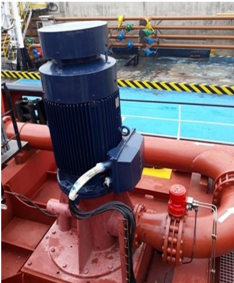
Ilustración 12: Bomba N° 3 de Fuel. Fuente: elaboración propia.
