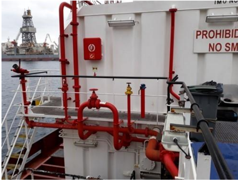
Ilustración 15: Sistema contra-incendio. Fuente: elaboración propia.
