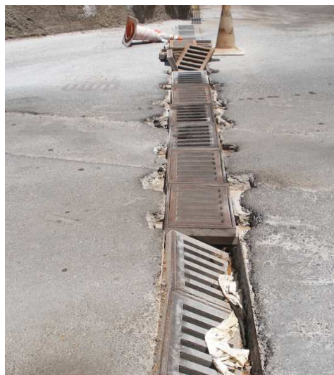
Figura 7: Detalle actual del imbornal
