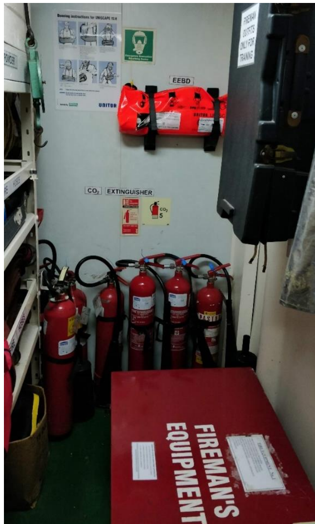
Ilustración 15. Pañol equipo contraincendios Loukas I. Fuente Creación propia:
