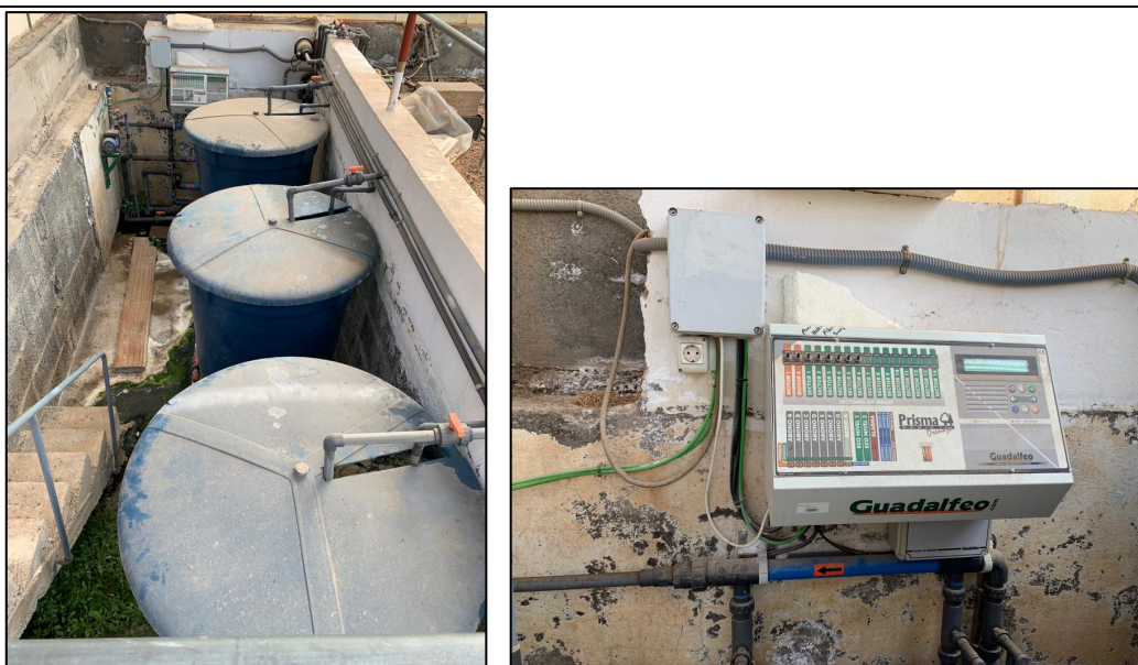
Fotografía 21 y 22. Depósitos (derecha) y controlador de riego(izquierda).
