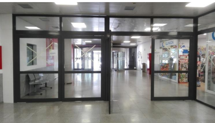
Acceso, con las nuevas puertas instaladas para evitar las corrientes de aire. La cafetería se encuentra cerrada desde hace meses
