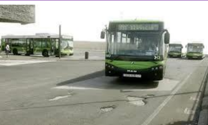
Pavimento dañado antes de la intervención
