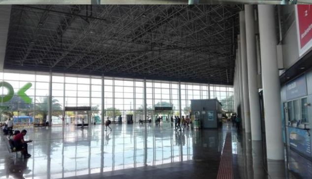
Caída del falso techo en 2011, y el estado actual. Sigue sin ser repuesto
