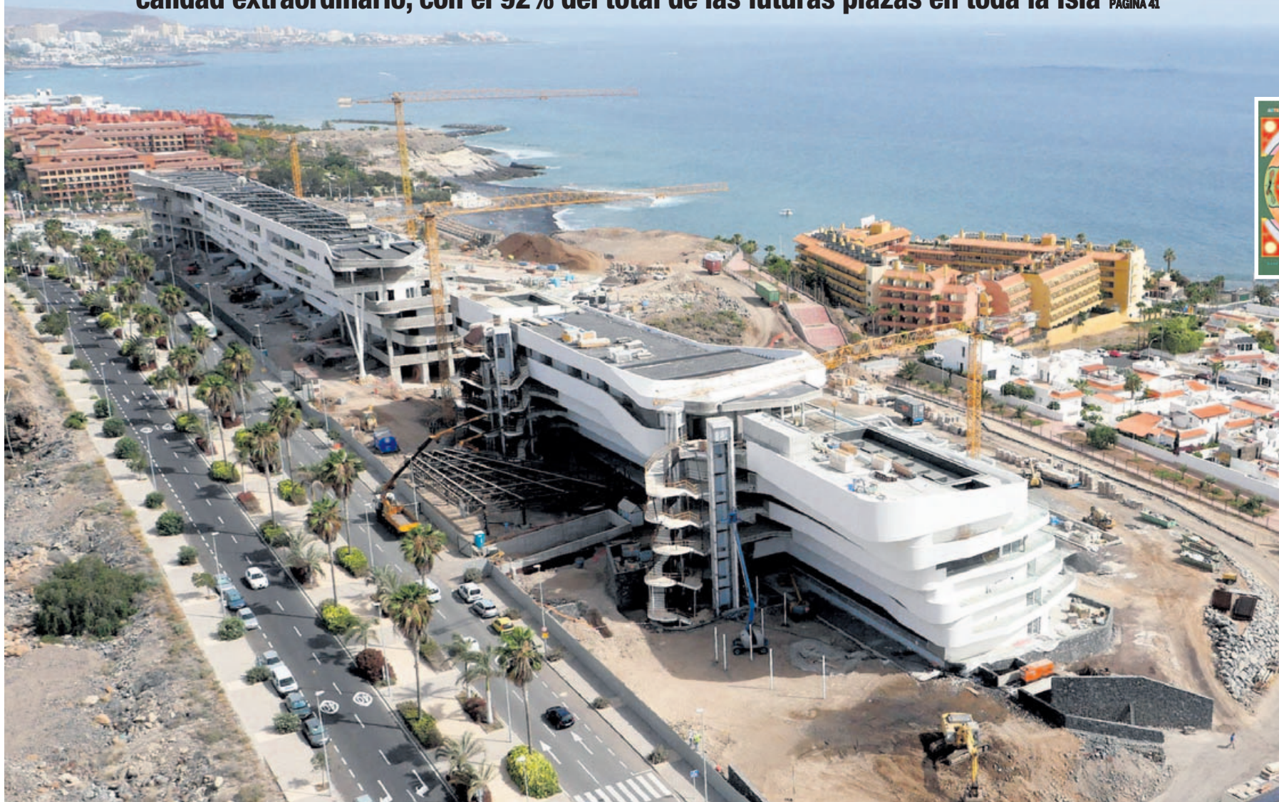
VISTA AÉREA DE LA CONSTRUCCIÓN DEL HOTEL ROYAL HIDEAWAY CORALES SUITES, EN LA CALETA (ADEJE), QUE HOY YA ES UNO DE LOS ESTABLECIMIENTOS REFERENTES DEL SEGMENTO DEL LUJO EN TENERIFE.
