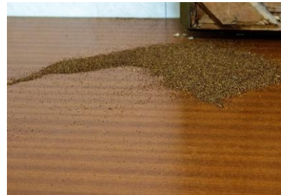
Fig.84 (arriba) roturas en el marco por debilitamiento de la estructura interna de la madera, provocados por un ataque de tipo biótico. Fig. 85 (abajo) acumulación de excrementos de insectos xilófagos que se encontraban en el interior del marco.
