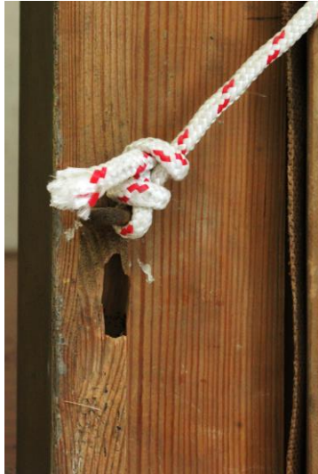
Fig.83 Agujeros en la madera por presencia de carcoma
