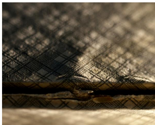
Figura 12.- Detalle del nervio bajo la guarda con luz rasante. Imagen del autor.
