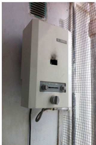
Figura 11. Sistema individual de ACS. Termo de gas butano. Fuente: (MUVISA, 2018).
