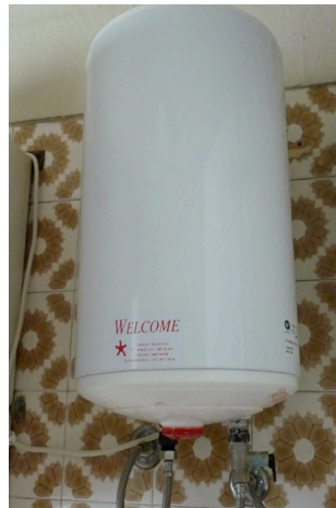
Figura 12. Sistema individual de ACS. Termo eléctrico. Fuente: (MUVISA, 2018).
