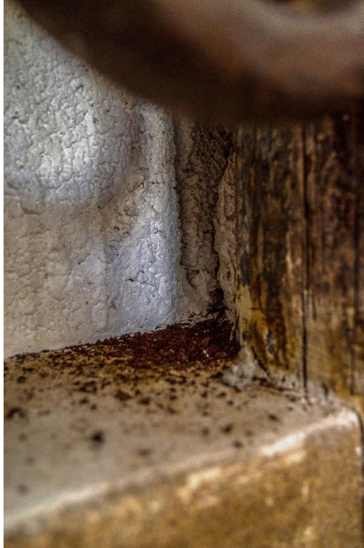
14. D - 7 Acumulación de herrumbre
