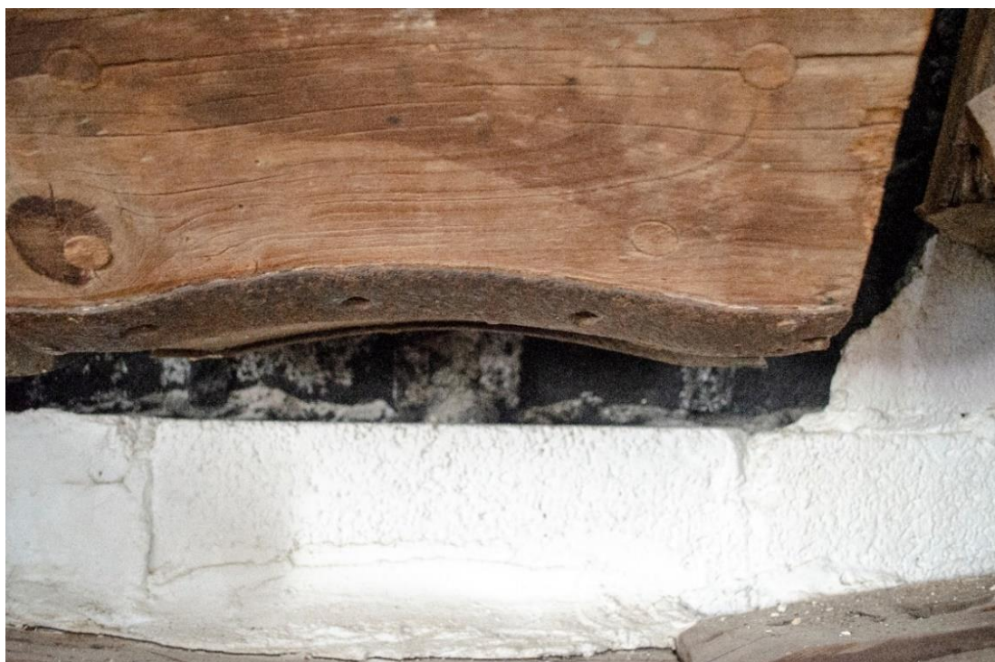
34. D - 13 Sulfatación blanca en el muro
