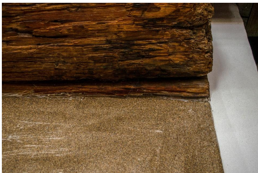
28. D – 11.12 Detalle de grieta. Zona inferior del mural
