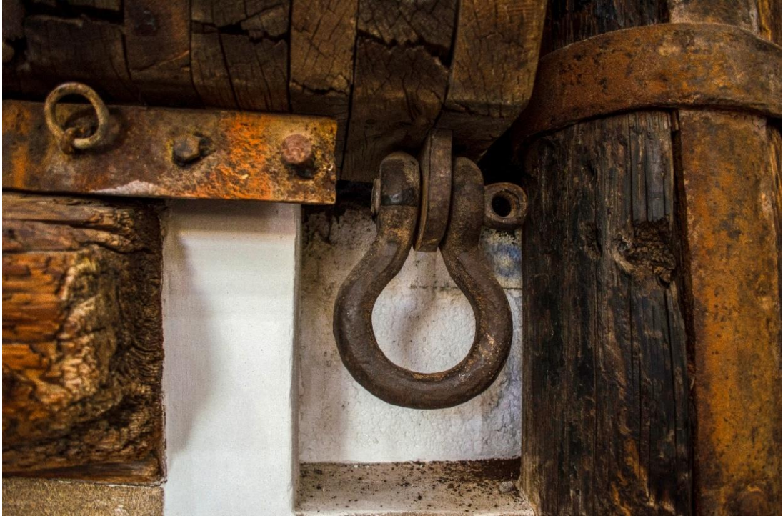
13. D.E – 6.7 Zona de oxido y acumulación de herrumbre
