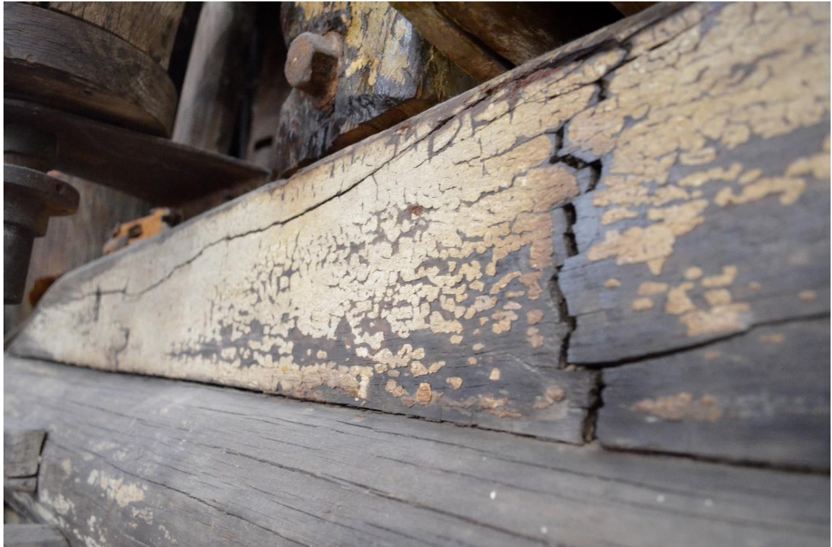
32. C – 10.11 Descamación de pintura original
