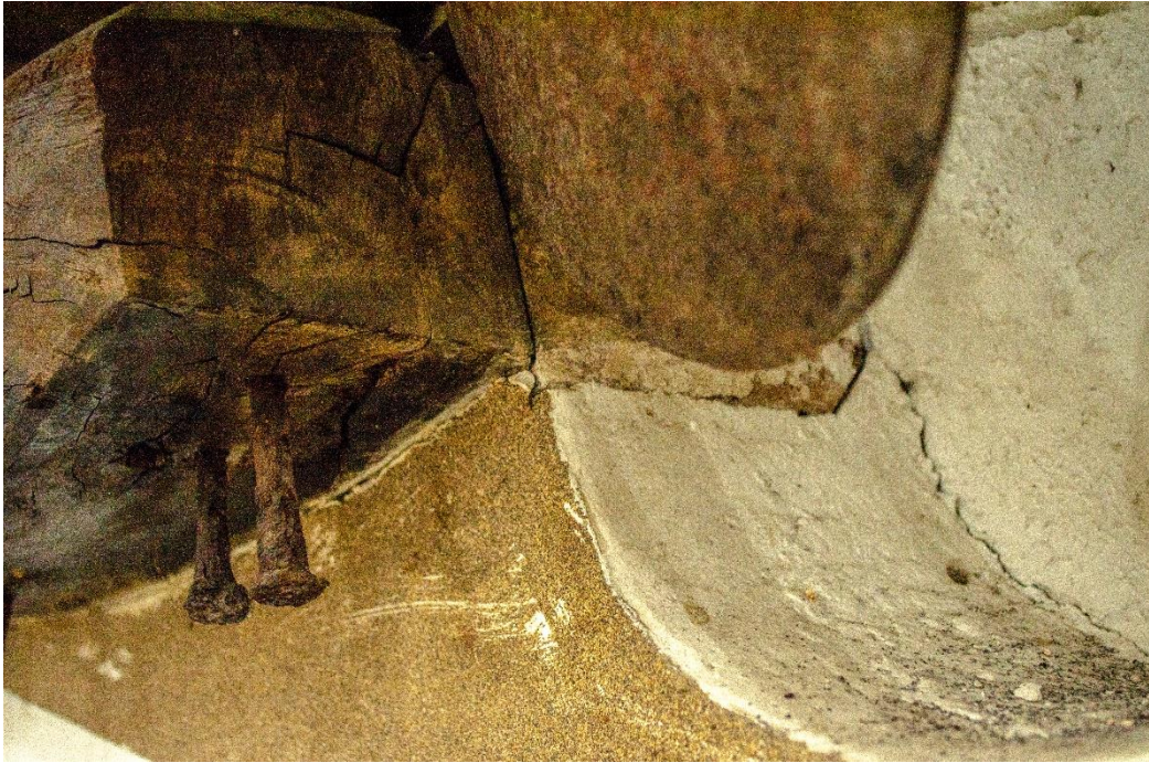
36. D - 14 Grieta en la parte inferior
