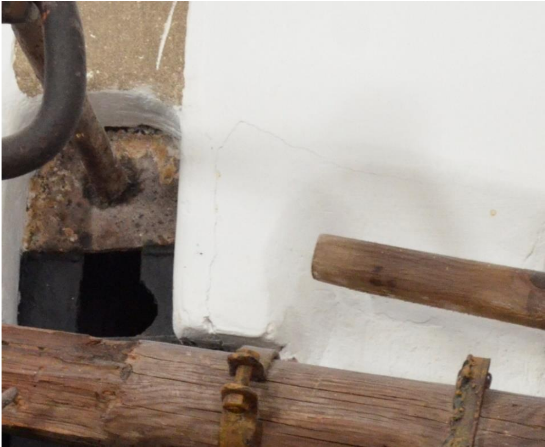
33. B - 12 Grieta en la parte superior
