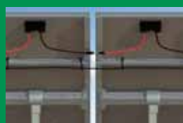
2 Conexión entre placas y paneles fotovoltaicos
