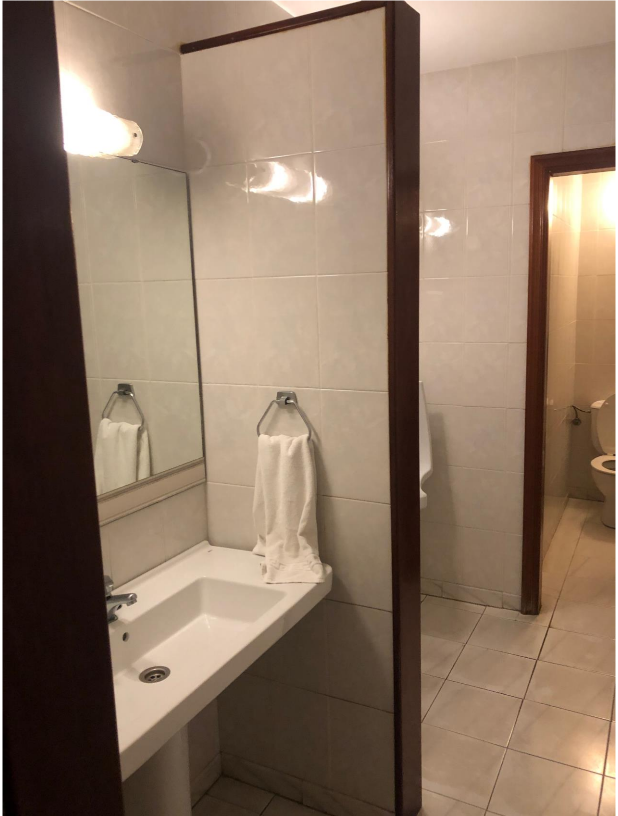
Baños del comedor inaccesibles, además presentan un estado de deteriorado
