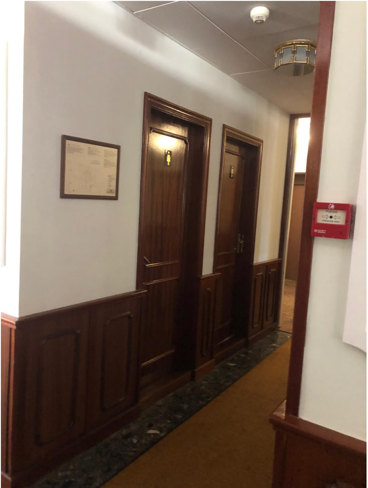
Acceso a los aseos del comedor, presenta un desnivel de 10cm
