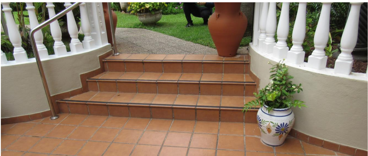
Acceso al edificio 3, presenta un desnivel de 51cm
