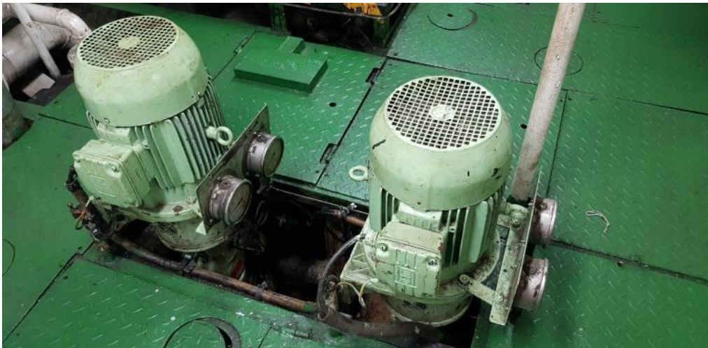
Ilustración 17: Bombas de trasiego de HFO y GO
