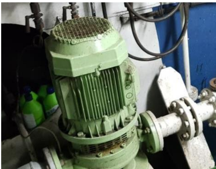
Ilustración 20: Bomba de agua salada de alimentación del evaporador
