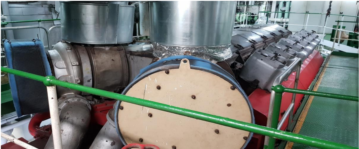
Ilustración 47: Vista del motor principal desde proa
