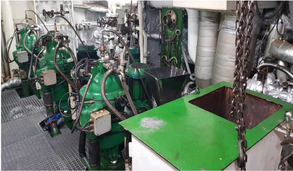
Ilustración 29: Vista de la sala de depuradoras desde proa
