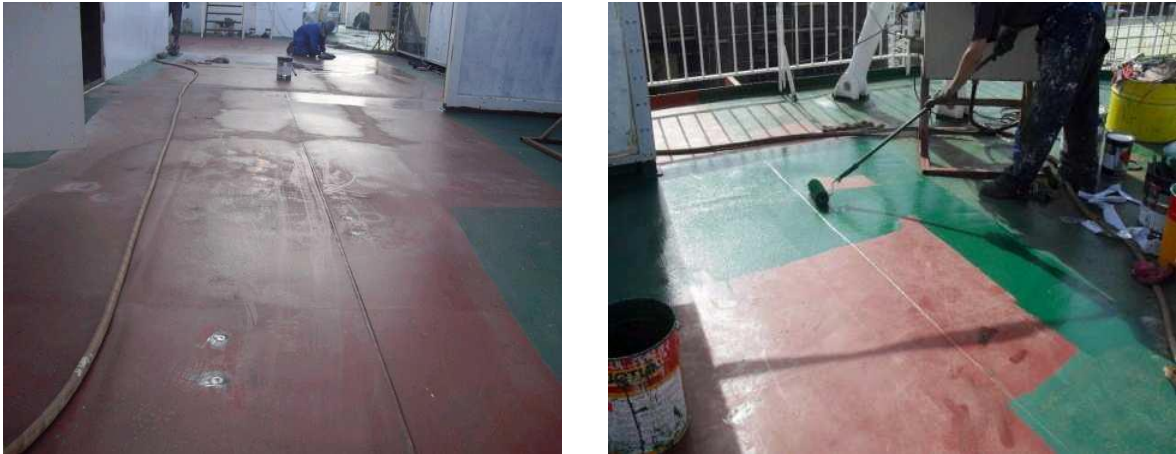
Ilustración 58: Limpieza superficie con disolvente (izq) y pintado con rodillo (dcha) capa HEMPADUR MASTIC (n° 45880 – 40640)
