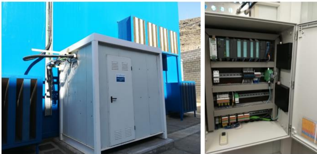
Figura 19 Cabina situada junto a la turbina de Gas 1 (izquierda) y cuadro eléctrico en cabina (derecha)
