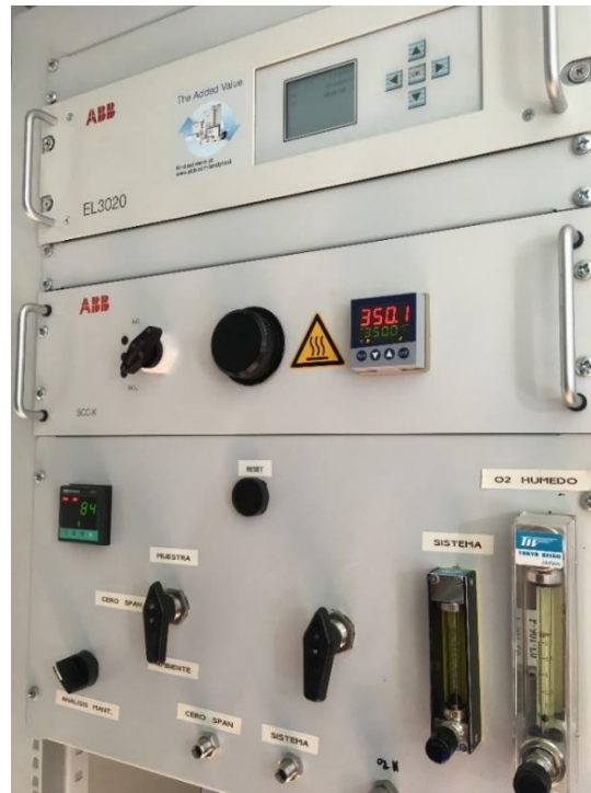
Figura 4 Instrumentos de medida en cabina
