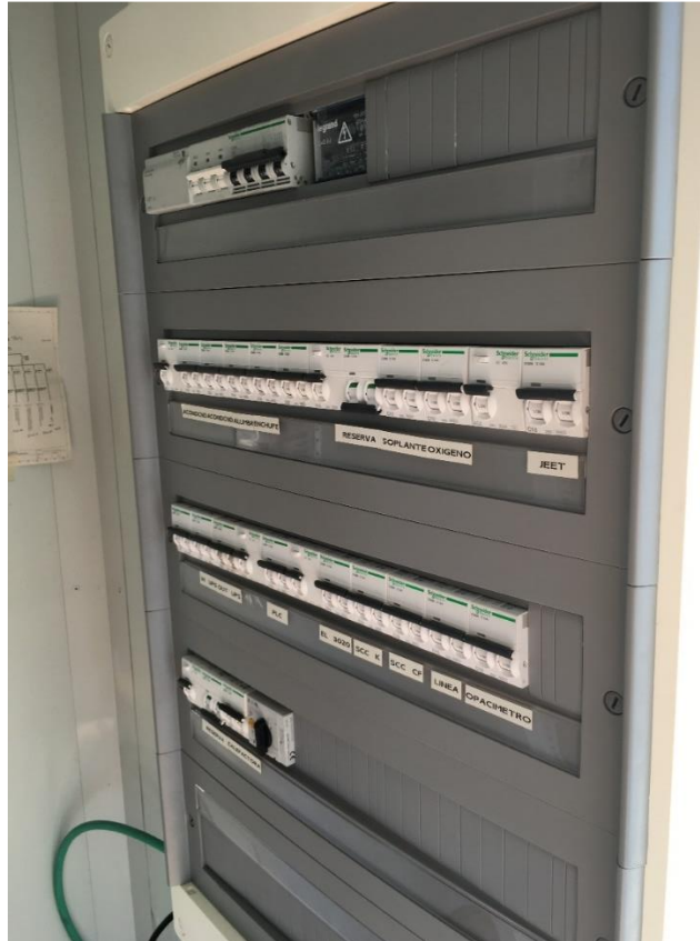
Figura 35 Cuadro de protecciones en cabina
