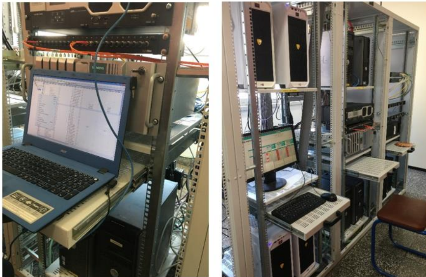
Figura 76 Carga de la programación en los PLC (izquierda). Monitor en la Sala de Electrónica con las pantallas de WinCC (derecha)
