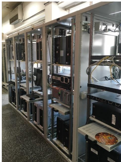
Figura 28 Sala de Electrónica
