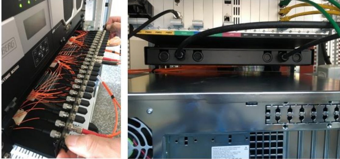
Figura 30 Cajetín de fusión de fibra para Gas 1 y Gas 2 (izquierda) y fibra óptica de Gas 1 y Gas 2 entrando al cajetín de fusión (derecha)
