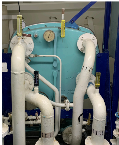
Ilustración 14: "Generador de agua dulce buque Tinirfe"
