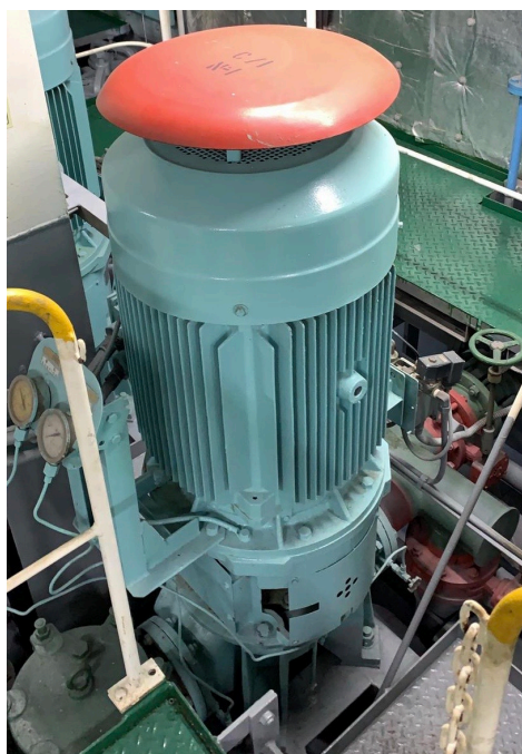
Ilustración 8: "Bomba contra incendios buque Tinerfe"
