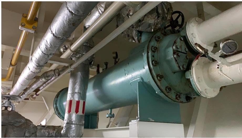
Ilustración 17: "Condensador de purga de la caldera buque Tinerfe"
