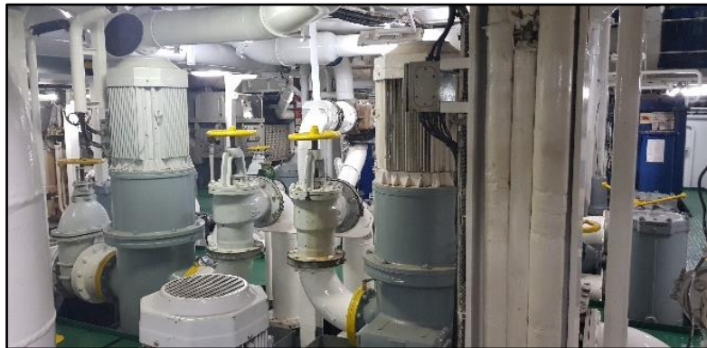
Ilustración 16: Bombas de reserva.
