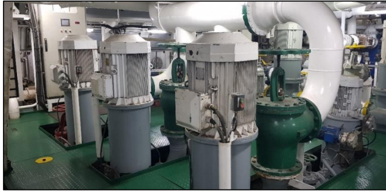
Ilustración 13: Bombas de circulación de agua salada.
