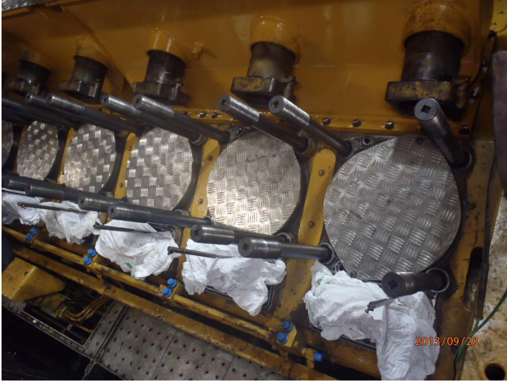
Ilustración 23 Ilustración orificios contenidos en bloque motor principal cubiertos para evitar entrada de agentes perjudiciales. Fuente: Trabajo de campo.
