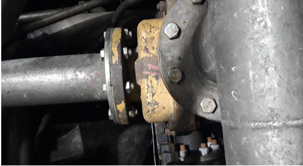
Ilustración 50 . Ilustración de válvula termostática del circuito de refrigeración. Fuente: Trabajo de campo.
