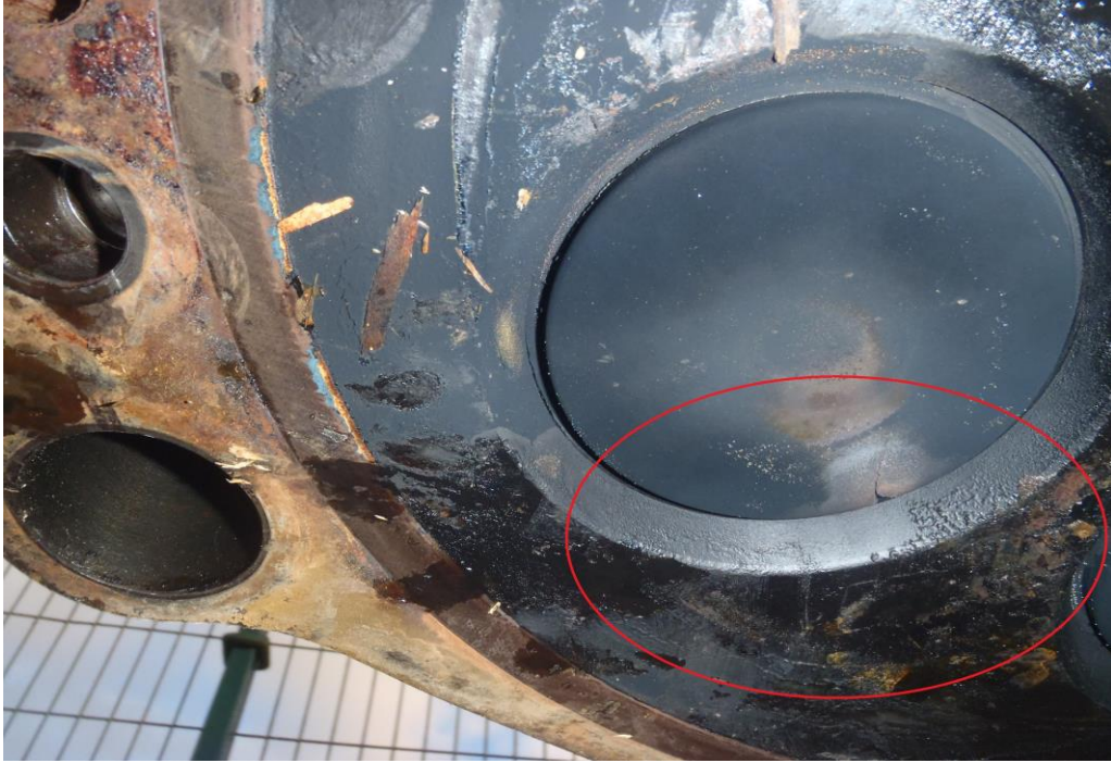
Ilustración 42 Ilustración de culata CAT 3618 presenta corrosión y grieta en la cabeza de la válvula. Fuente: Trabajo de campo.
