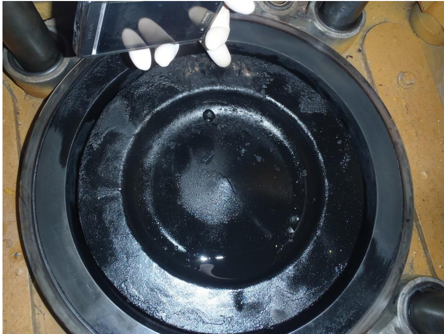
Ilustración 29 Ilustración fisura en pistón nº15 del SIME. Fuente: Trabajo de campo.
