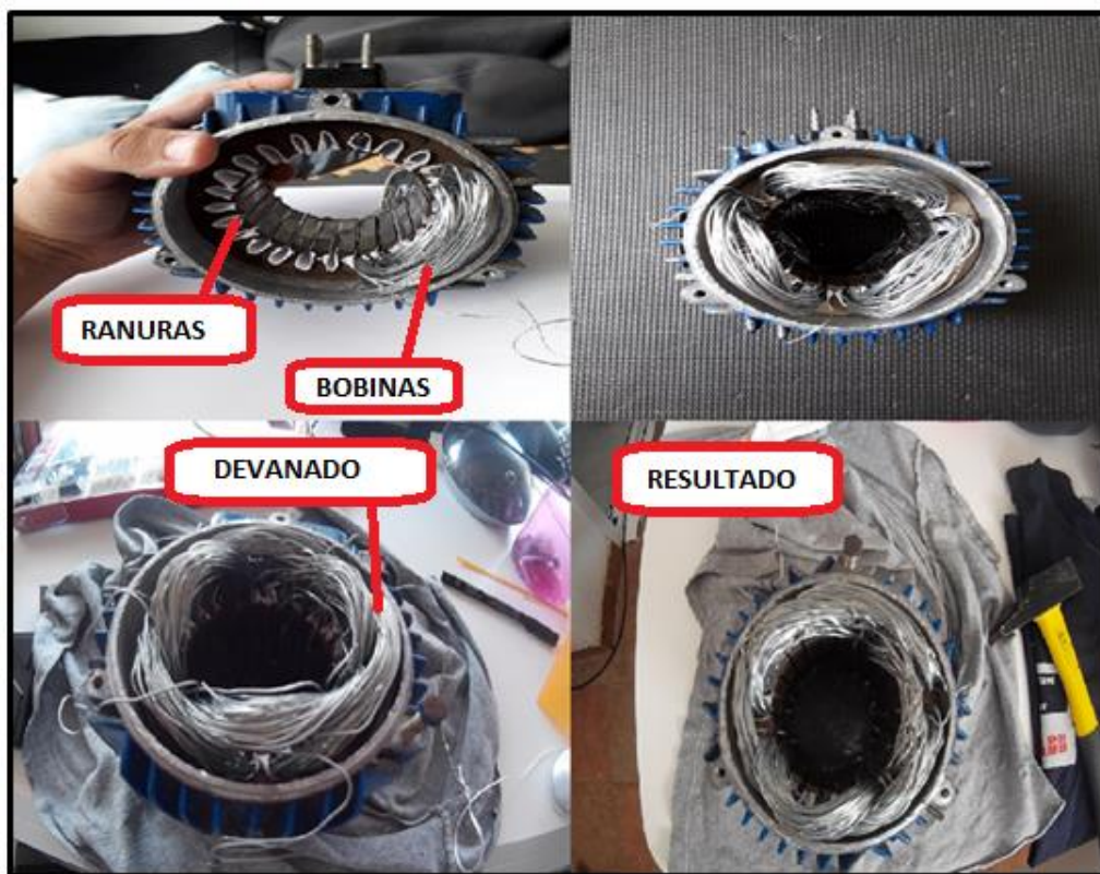
Ilustración 68. Proceso de colocación de las bobinas en el estator. Fuente: Elaboración propia.
