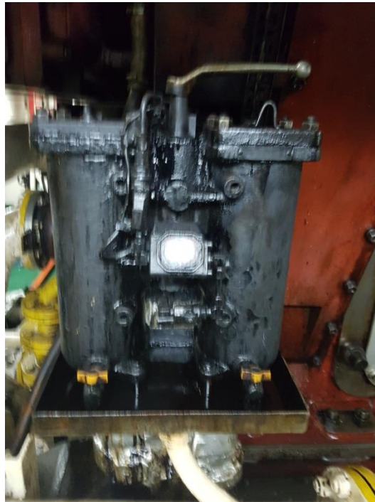
Ilustración 34. Filtro de aceite sucio. Fuente. Trabajo de campo.
