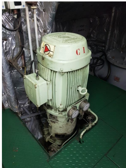
Ilustración 15. Bomba Contra Incendios. Fuente. Trabajo de campo.
