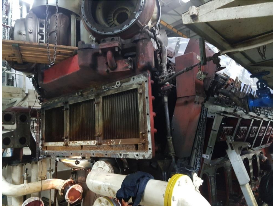
Ilustración 33.MP Enfriador A.D. Fuente. Trabajo de campo.
