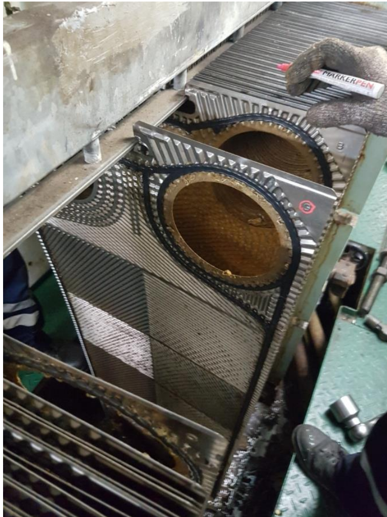
Ilustración 18. Enfriador principal A.S. Fuente. Trabajo de campo
