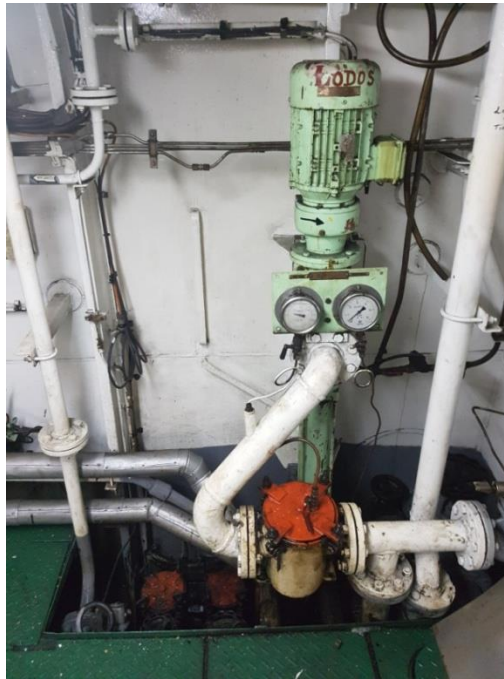
Ilustración 14. Bomba de lodos. Fuente. Trabajo de campo.
