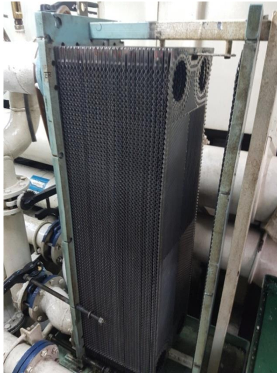
Ilustración 19. Enfriador principal A.S. Fuente. Trabajo de campo
