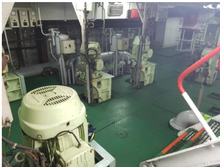
Ilustración 17. Sala de Bombas montada. Fuente. Trabajo de campo.
