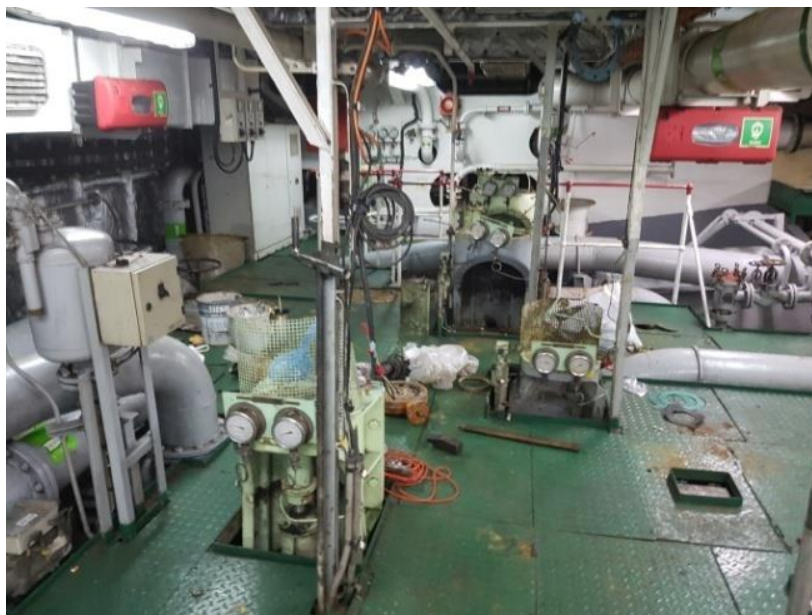
Ilustración 16. Sala de Bombas desmontada. Fuente. Trabajo de campo.
