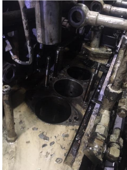
Ilustración 38. Motor Ruston. Fuente. Trabajo de campo
