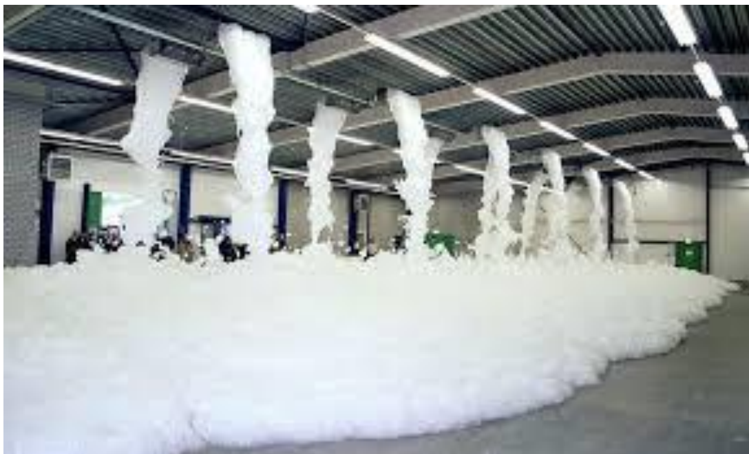
Imagen 37: Espuma de alta expansión inundando una nave - Fuente: Prefire.es
