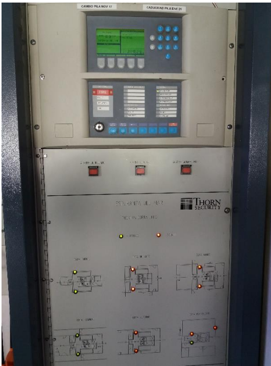
Imagen 30: Cuadro de control contra incendios - Fuente: Buque Esperanza del Mar
