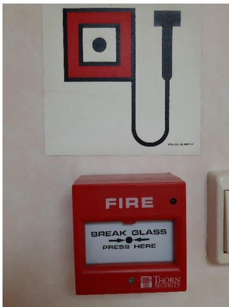
Imagen 33: Pulsador de alarma contra incendios - Fuente: Buque Esperanza del Mar
