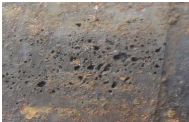
Figura 12: Corrosión por picadura en un metal. Fuente: (12)
