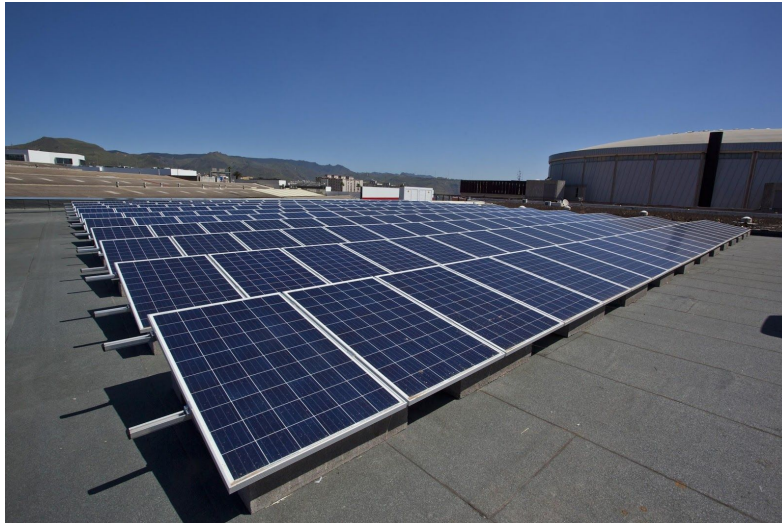
Imagen: Planta fotovoltaica situada en la azotea del edificio.
