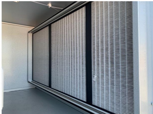
Imagen: Unidad de tratamiento del aire exterior (D-AHU) de bajo consumo energético.
