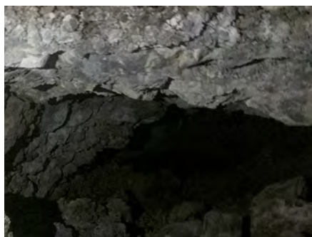
Fig. 5d. Presencia de derrumbes en el interior de la cueva de las Calzadas.
