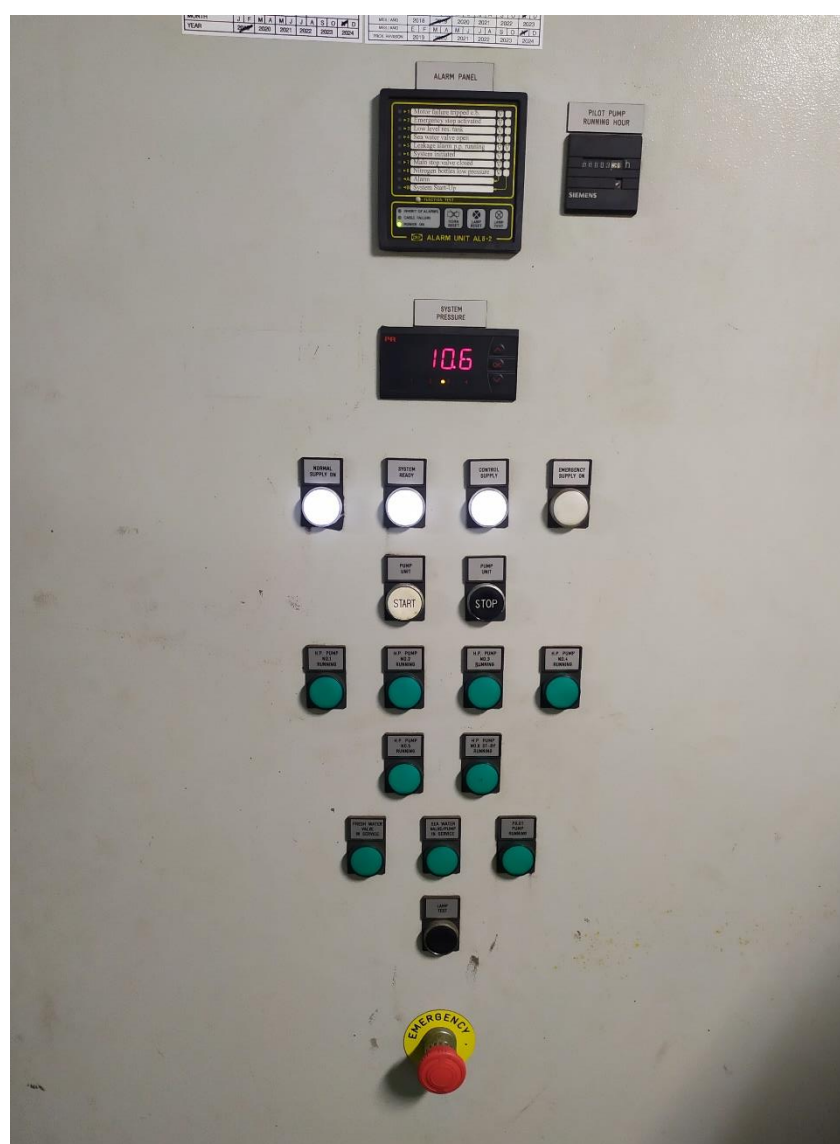
Imagen 6. Panel de control del sistema. Fuente: Elaboración propia.
