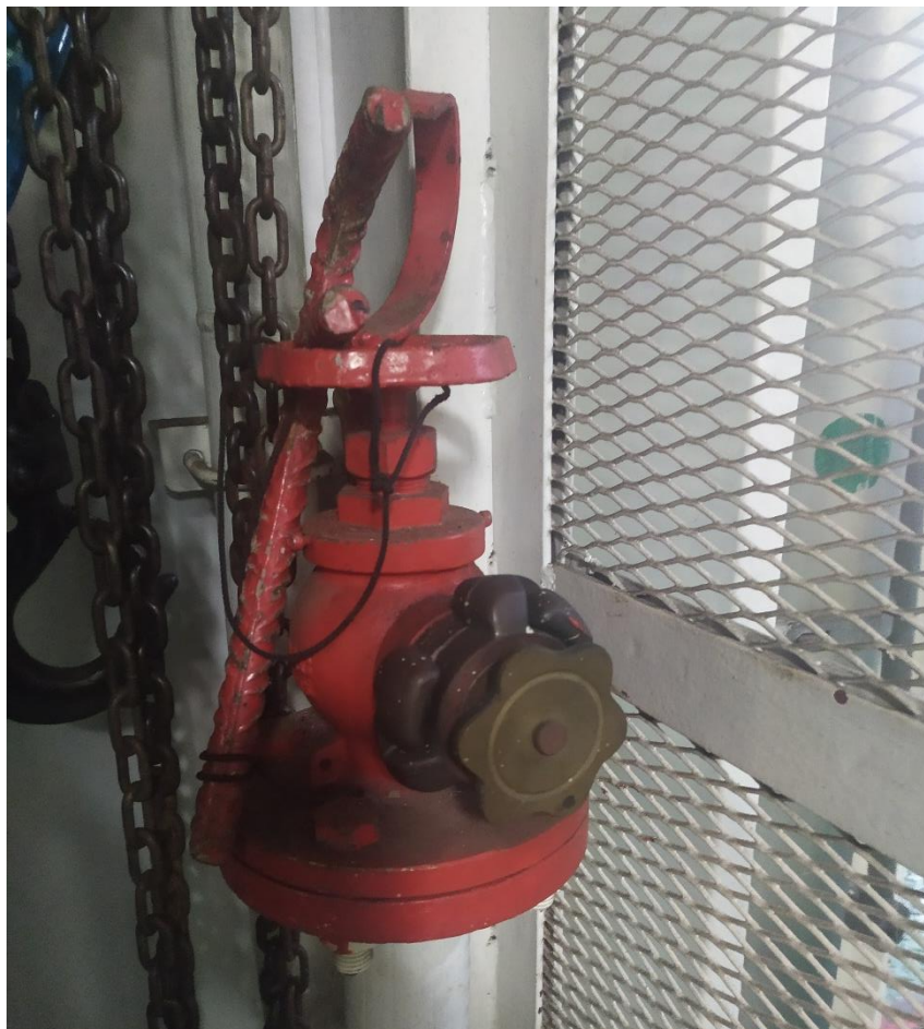
Imagen 29. Hidrante de la zona de máquinas. Fuente: Elaboración propia.
