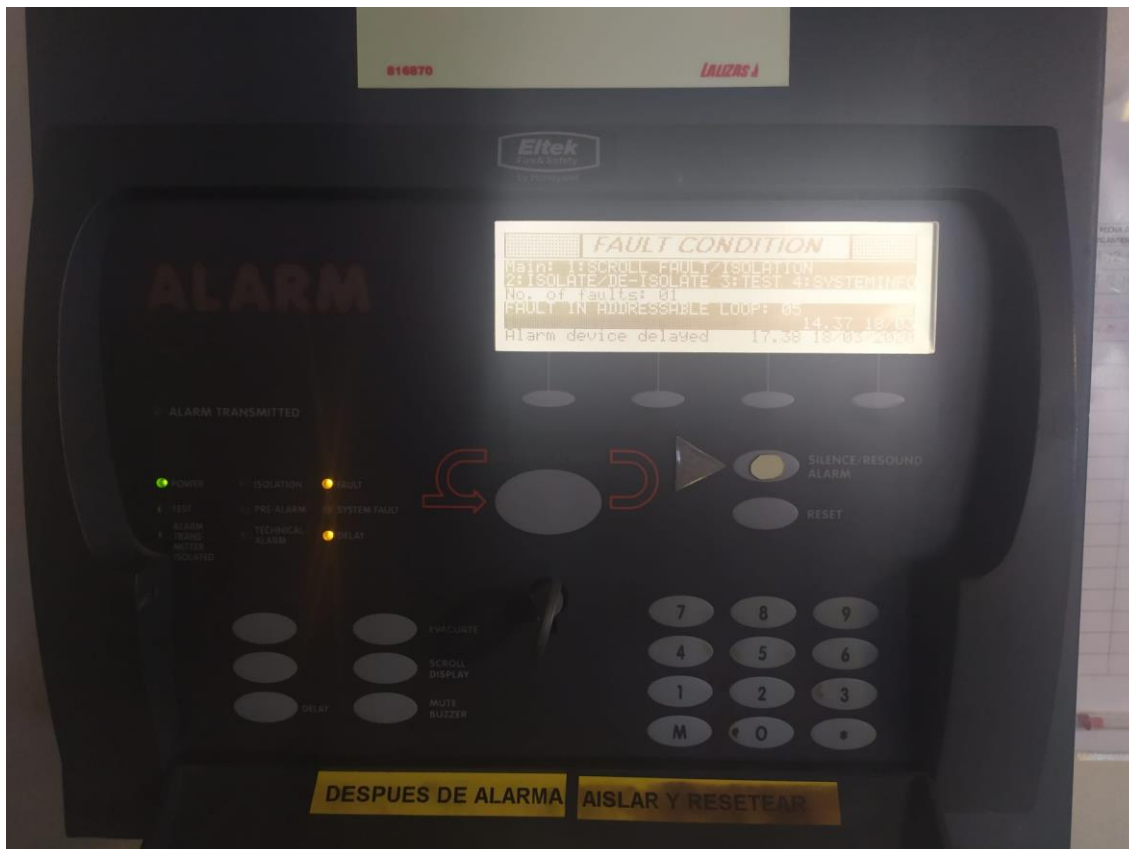
Imagen 16. Central contra incendios. Fuente: Elaboración propia.
