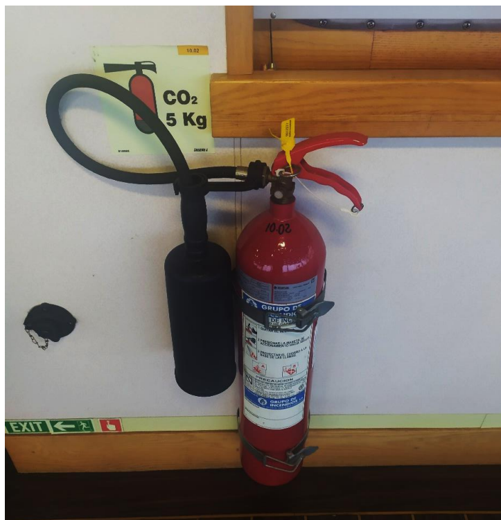
Imagen 13. Extintor de CO 2 de 5 kg. Fuente: Elaboración propia.
