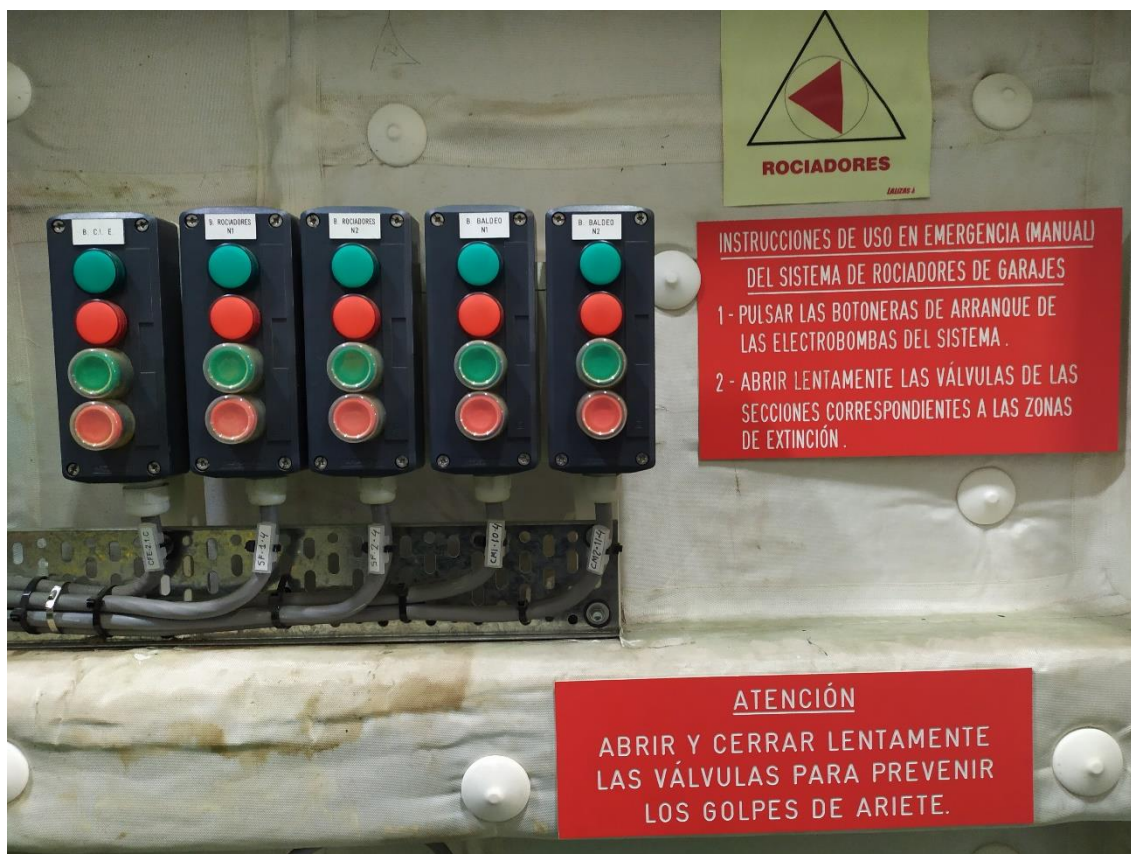
Imagen 8. Botonera de control de las bombas de rociadores. Fuente: Elaboración propia.
