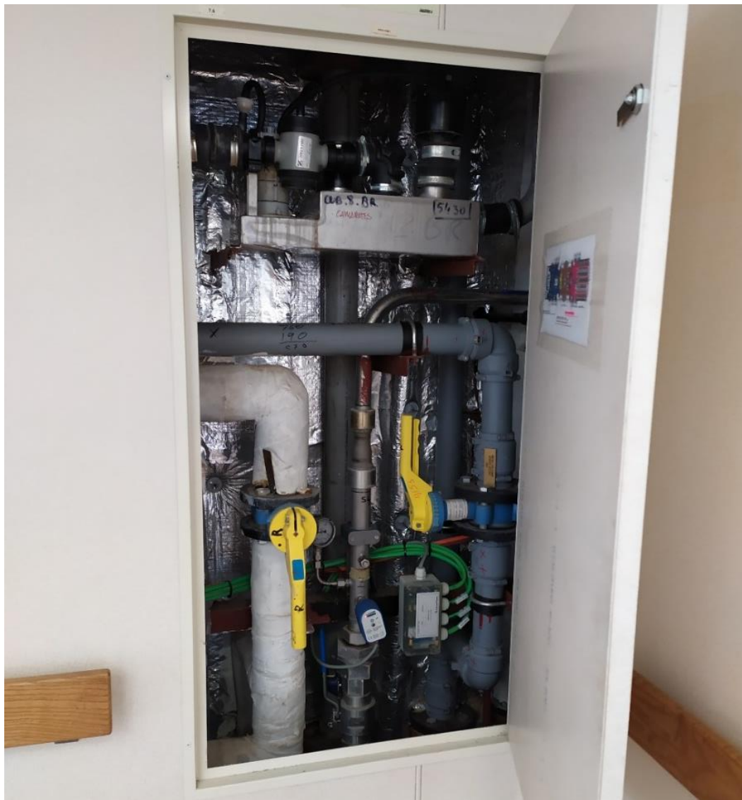
Imagen 4. Válvula de corte de la sección de la cubierta 9 proa. Fuente: Elaboración propia.
