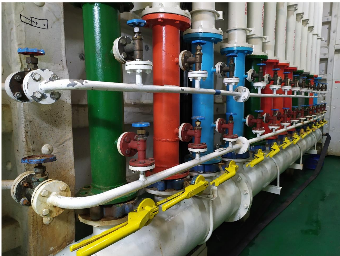
Imagen 7. Local de rociadores. Fuente: Elaboración propia.
