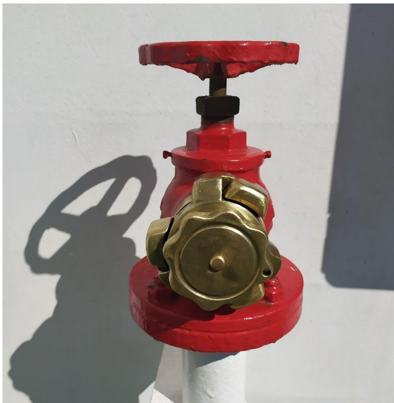
Imagen 27. Hidrante. Fuente: Elaboración propia.
