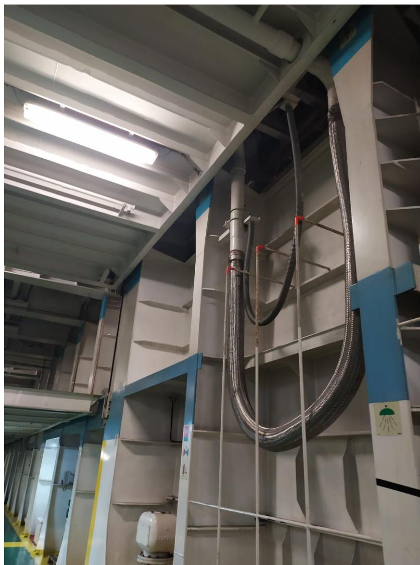
Imagen 11. Tubería flexible de un módulo del cardeck. Fuente: Elaboración propia.
