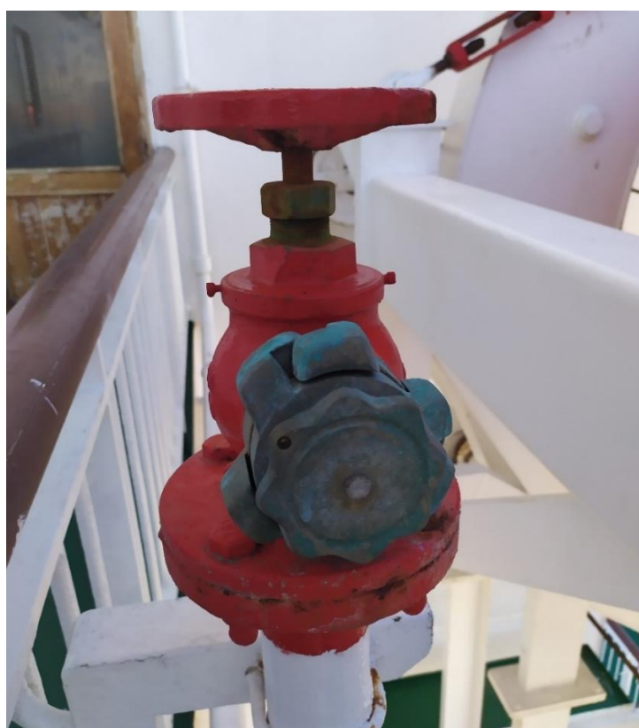
Imagen 28. Hidrante en mal estado. Fuente: Elaboración propia.
