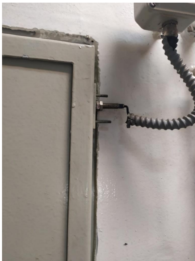
Imagen 32. Sensor de puerta contra incendios. Fuente: Elaboración propia.
