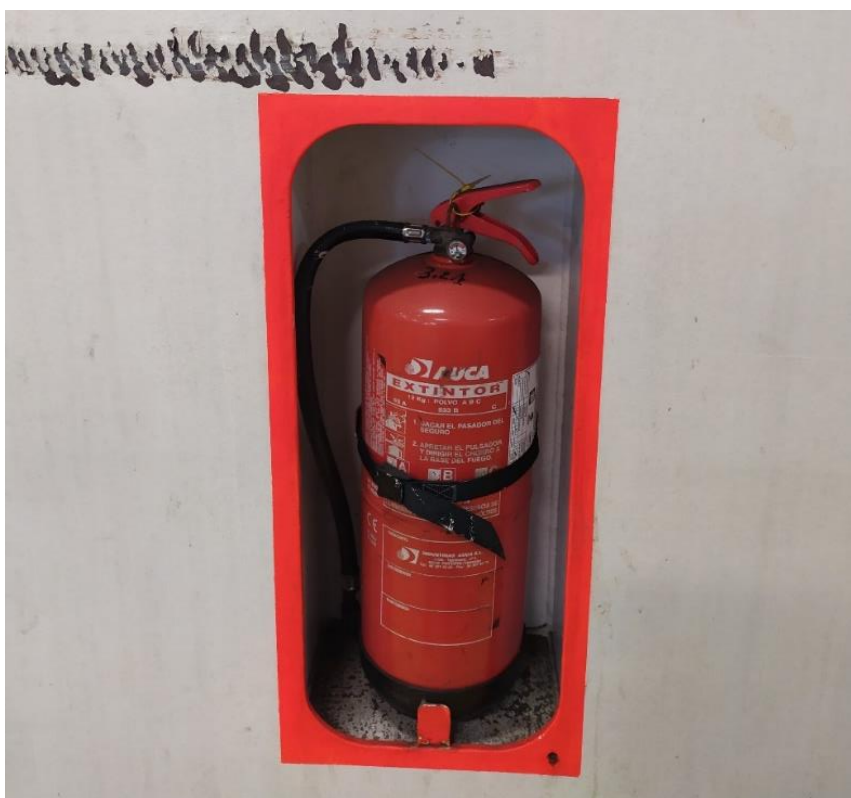
Imagen 12. Extintor de polvo seco de 6 kg. Fuente: Elaboración propia.
