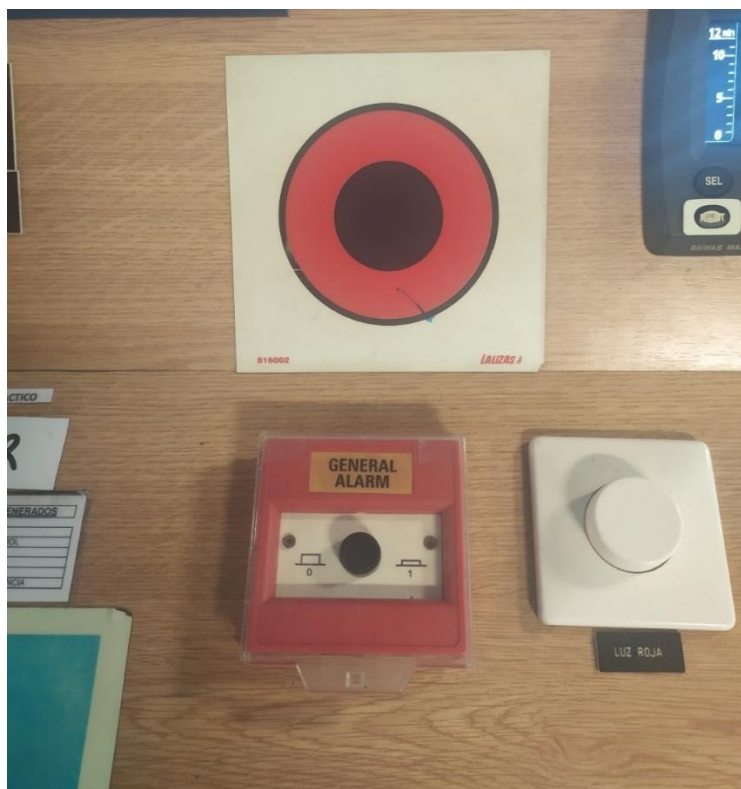
Imagen 17. Pulsador de alarma general. Fuente: Elaboración propia.
