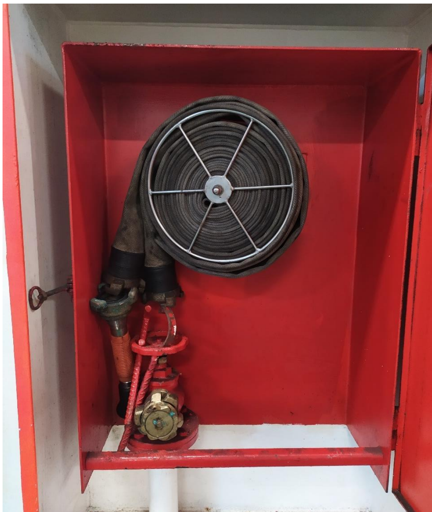
Imagen 30. Manguera, con hidrante y llaves “C” y “F”. Fuente: Elaboración propia.
