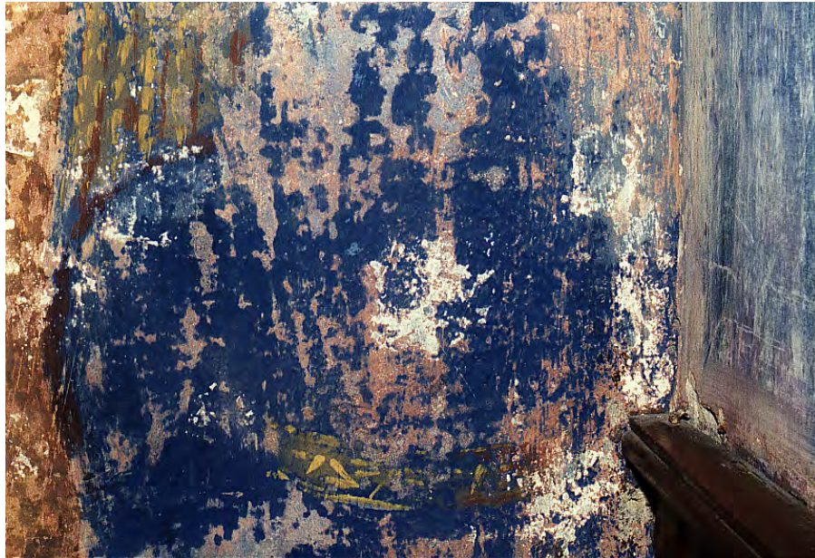
Fig. 4. Fotografía del mural en el presbiterio de la iglesia de S. Pedro (Güímar). Detalle conservación.
