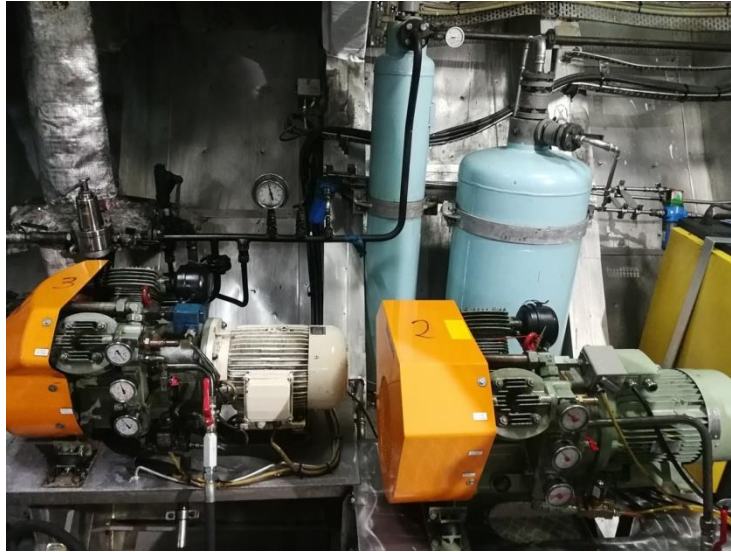
Ilustración 8: Compresores de aire de arranque
