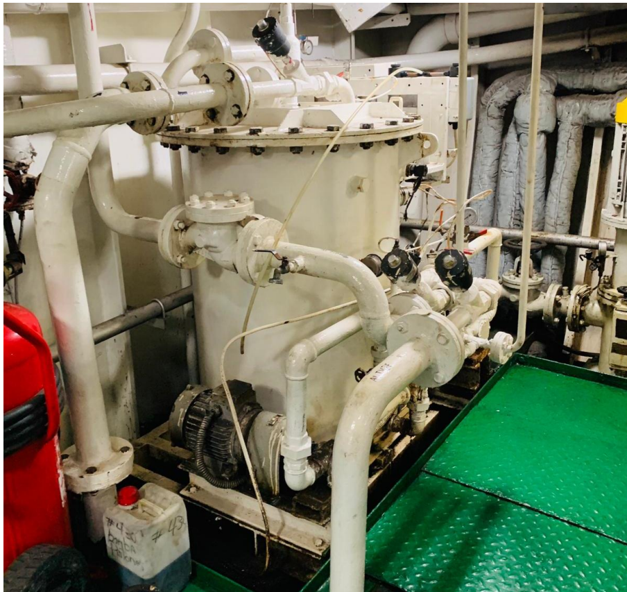
Ilustración 25: Separador de sentinas
