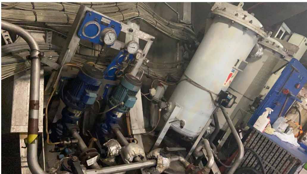
Ilustración 14: Bombas de trasiego DO y filtros
