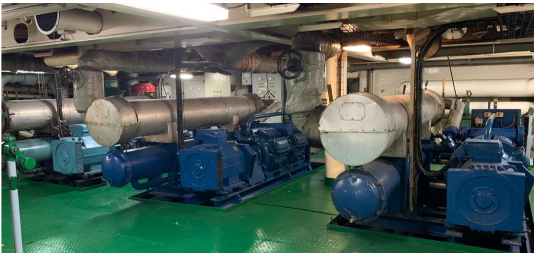
Ilustración 32: Equipos aire acondicionado
