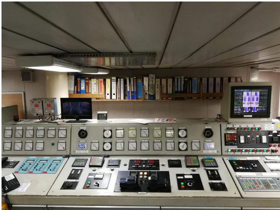
Ilustración 34: Control de máquinas
