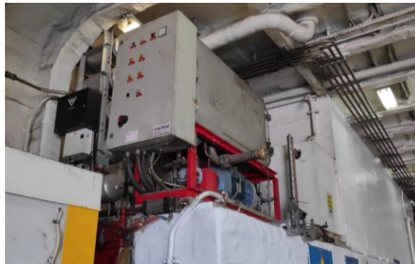
Ilustración 35: Tanque de compensación de aceite
