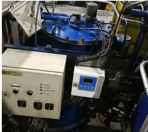
Ilustración 10: Separador de sentinas
