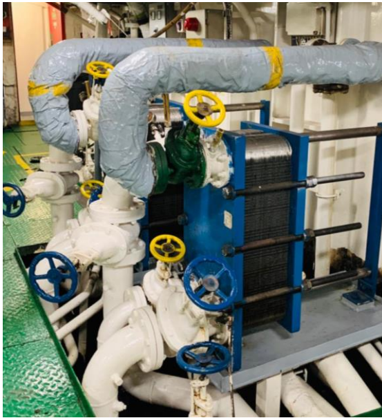
Ilustración 22: Enfriador de aceite
