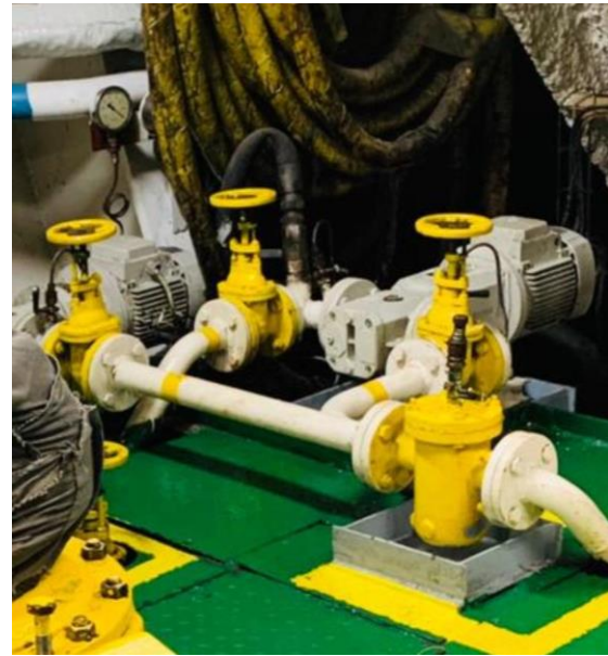
Ilustración 23: Bombas trasiego aceite
