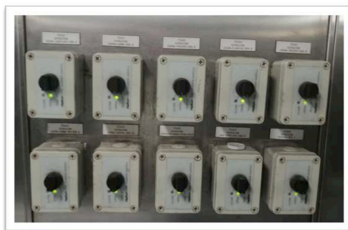
Ilustración 52 CIERRE DE VENTLACIÓN DE LA COCINA
