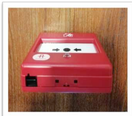
Ilustración 15 PULSADOR DE ALARMA
