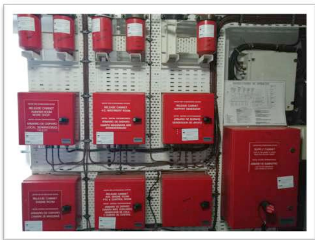
Ilustración 48 ARMARIOS DE DISPARO DEL CO2
