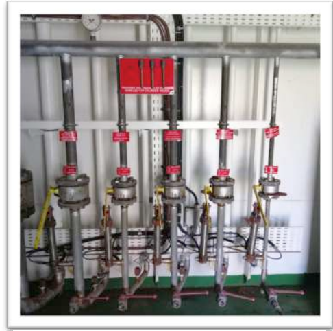
Ilustración 51 VALVULAS DE SECCIONES CO2
