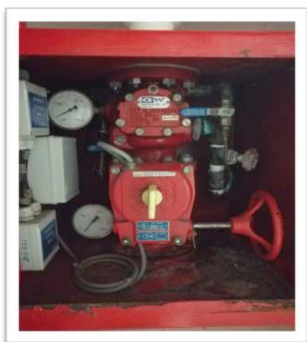
Ilustración 44 CAJA DE SECCIÓN SPRINKLER
