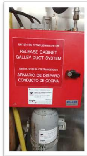
Ilustración 54 ARMARIO DE DISPARO DEL CO 2 DE LA COCINA
