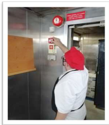
Ilustración 62 ACTUACIÓN DE LA ALARMA C.I
