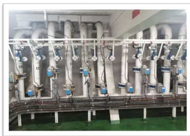
Ilustración 47 VALVULAS DE LAS SECCIONES DRENCHER
