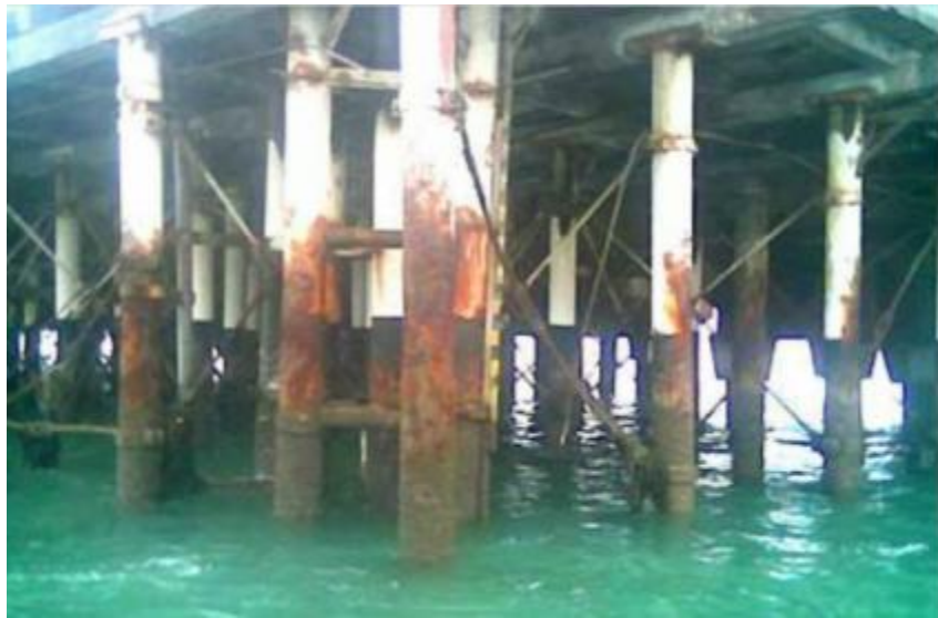
Ilustración 8: Corrosión por el medio ambiente
