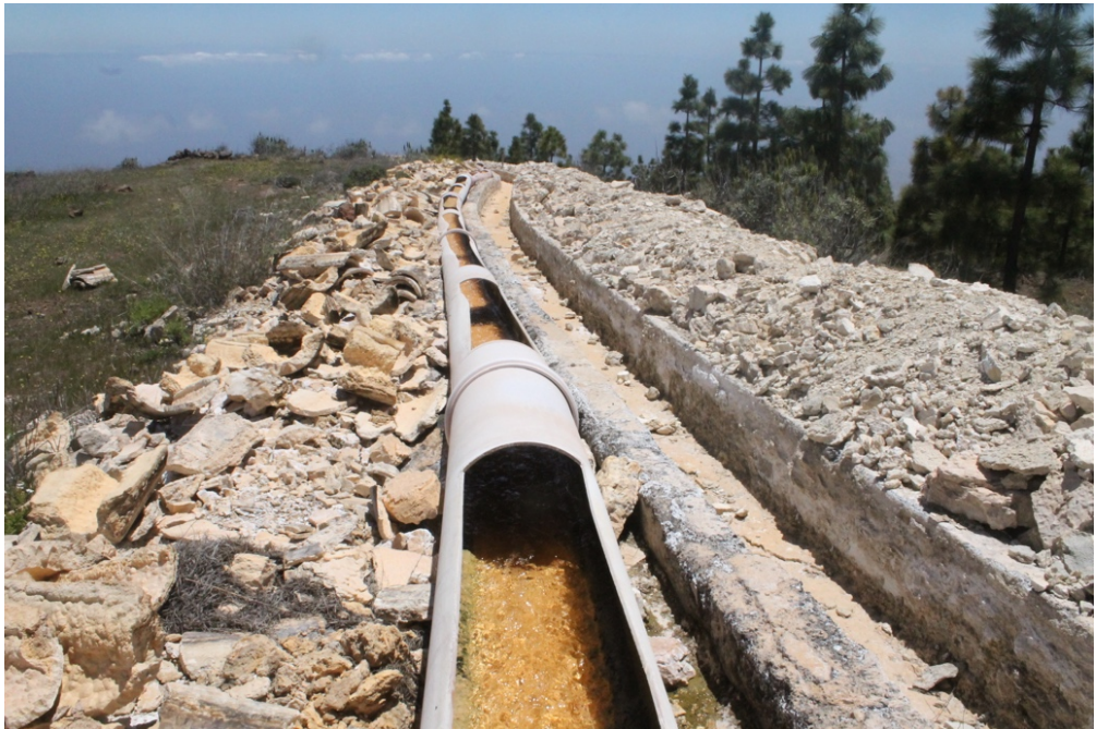
Figura 12.8. Conducciones de aguas subterráneas afectadas por depósitos de carbonatos en el sur de la isla de Tenerife
