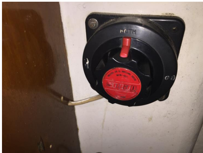
Ilustración 20: Desconectador de batería
