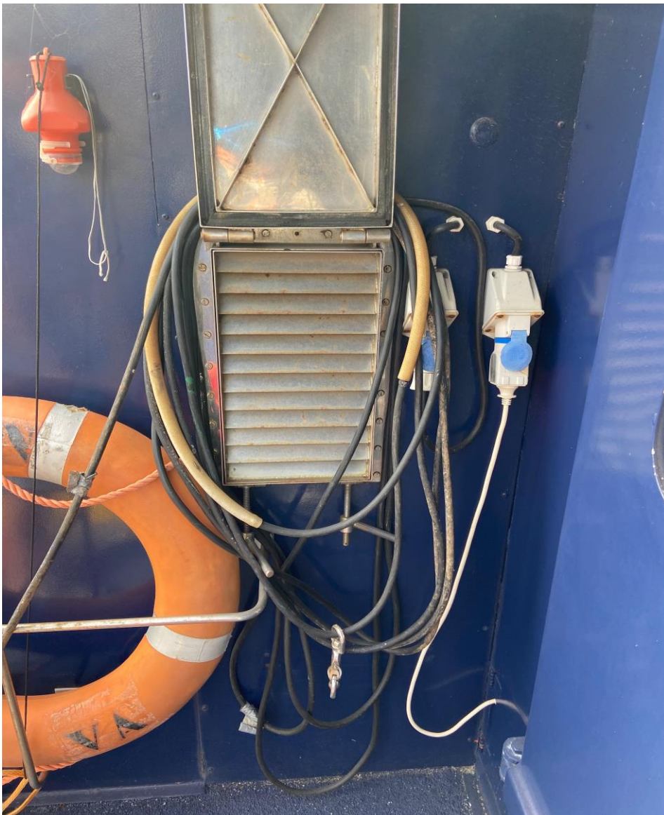
Ilustración 10: Cable de conexionado a tierra
