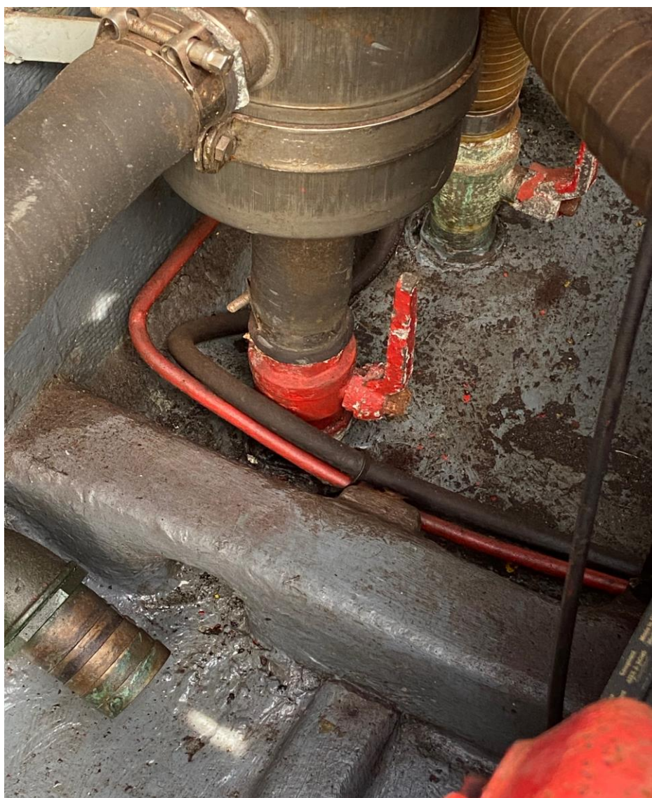
Ilustración 16: Toma de mar 1
