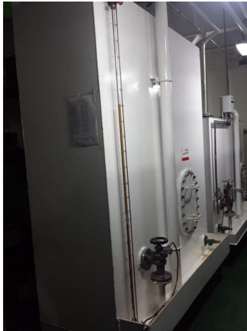
Ilustración [50]. Tanque almacén aceite.
