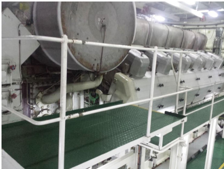
Ilustración [23] Motor principal de la planta de propulsión de un buque.
