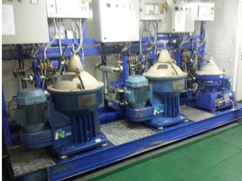
Ilustración [17] Depuradoras de Fuel Oil y Diesel oil
