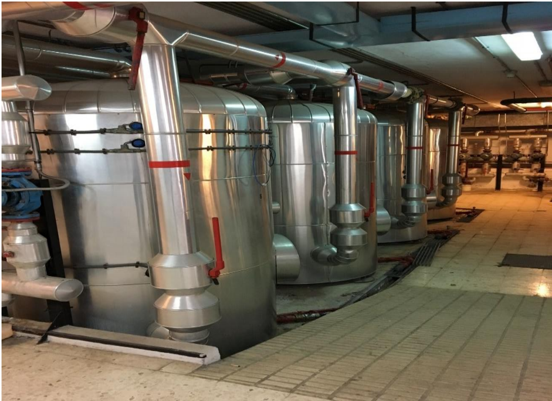
Ilustración X. Depósitos acumuladores 3, 4 ,5 y 6.
