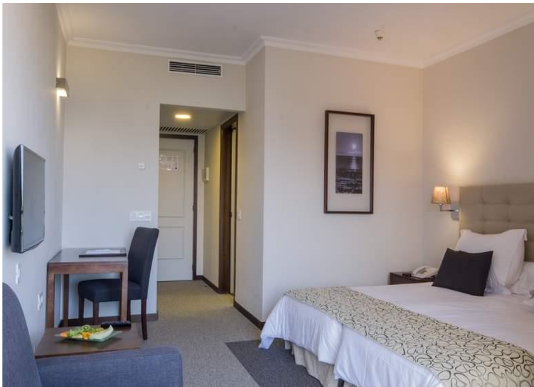
Ilustración VI. Rejilla de impulsión en instalación de climatización de las habitaciones.
