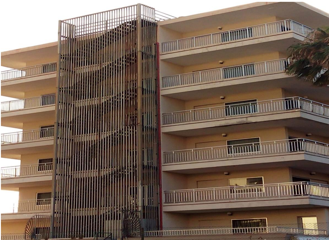
Ilustración XIII. Escaleras contra incendios exteriores en la fachada sur del hotel.
