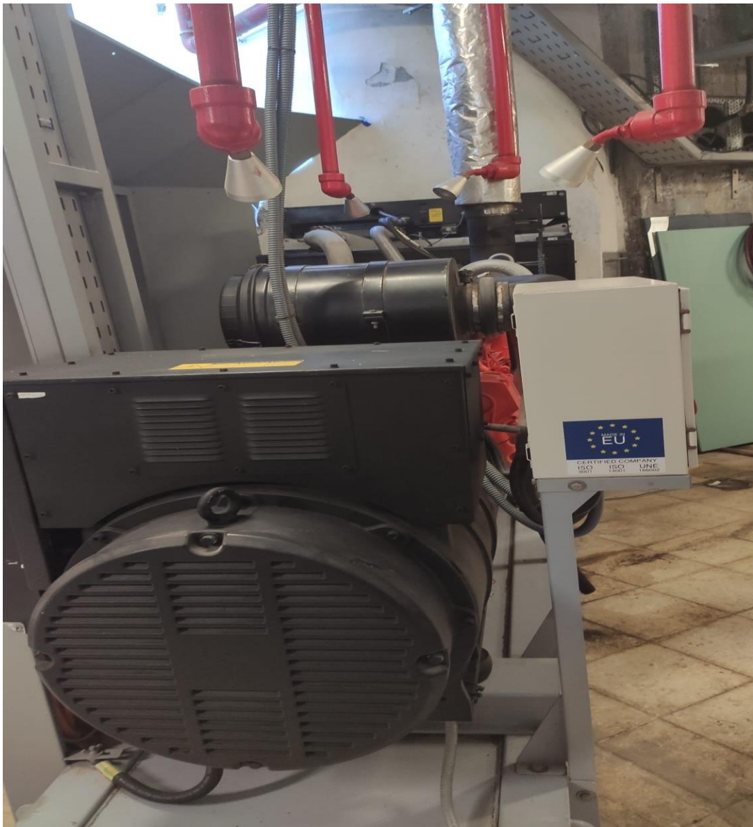
Ilustración XVII. Equipo de extinción por CO 2 para grupo electrógeno.
