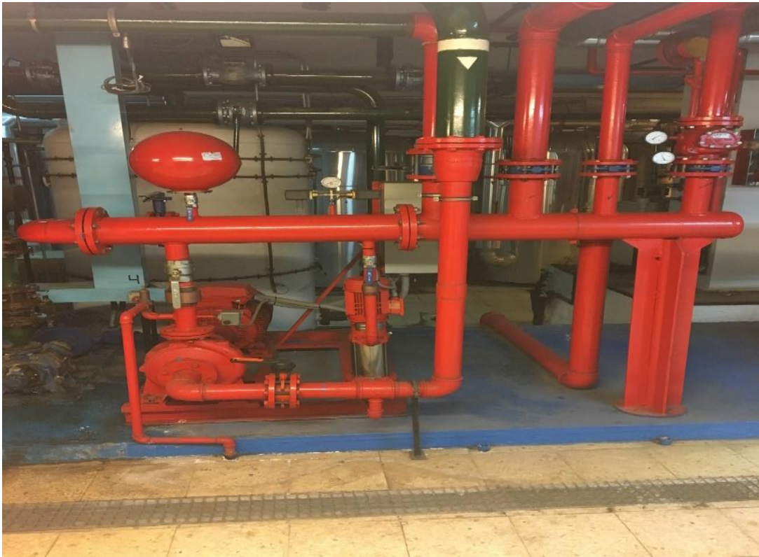
Ilustración XII. Grupo de presión de la instalación de PCI.
