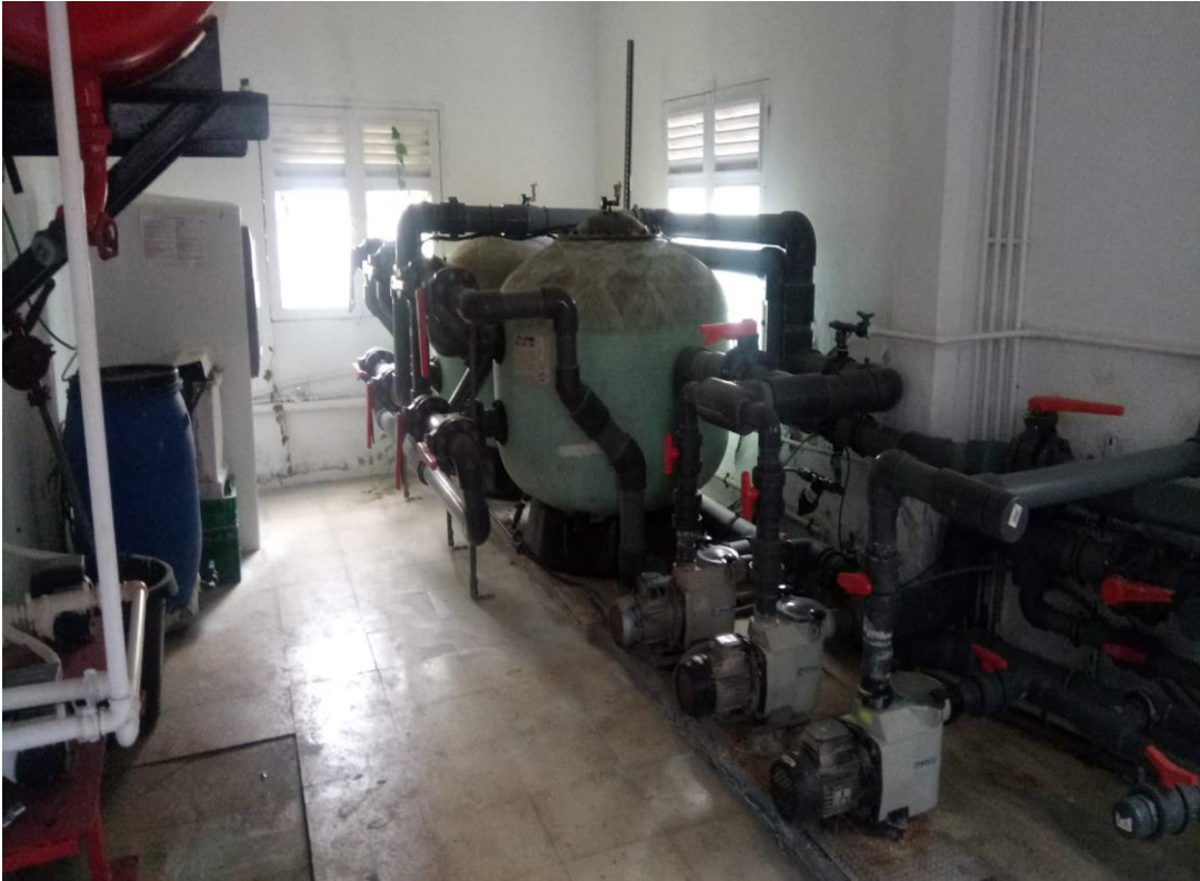
Ilustración XIV. Instalaciones de bombeo de la piscina.
