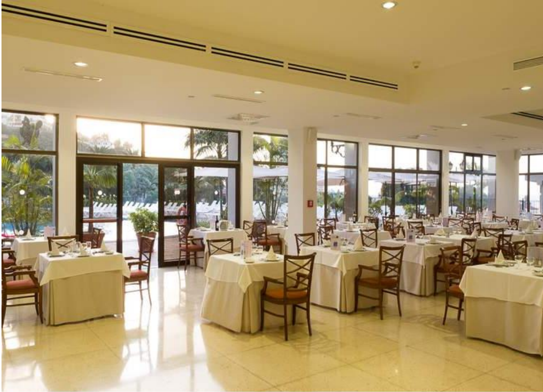
Ilustración VII. Rejillas de impulsión y aspiración en instalación de climatización del salón principal.
