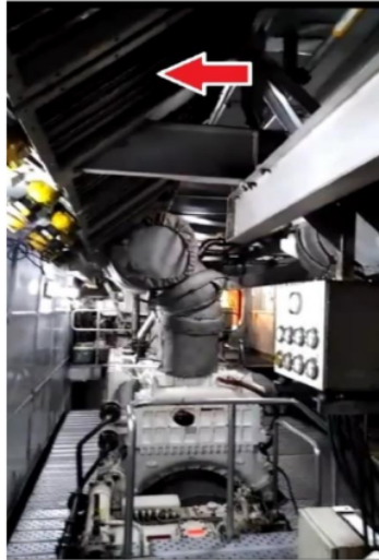
Ilustración 24: ventilación de la sala de máquinas
