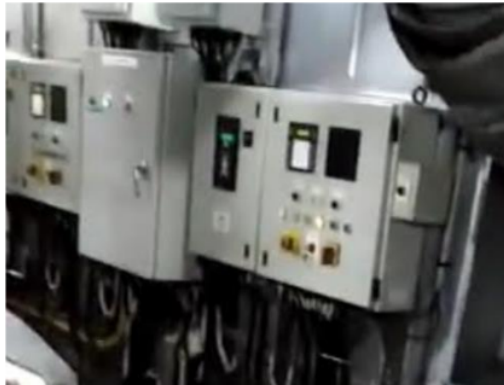
Ilustración 30: cuadro eléctrico del MP (sala de máquinas)
