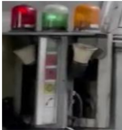
Ilustración 9: señales luminosas de la sala de máquinas
