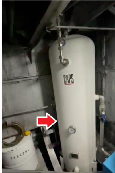
Ilustración 41: depósito de aire presurizado (sala de máquinas)
