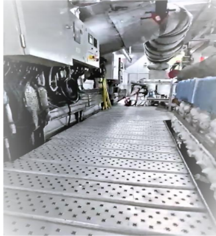
Ilustración 42: presencia de neblina en sala de máquinas
