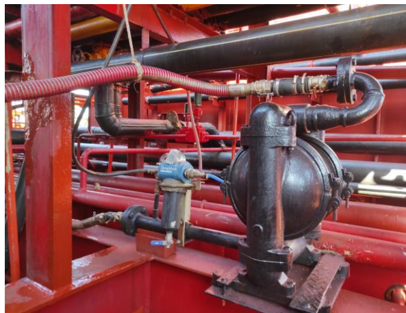
Ilustración 50. Bomba Depa de Cubierta. Fuente: Trabajo de campo.
