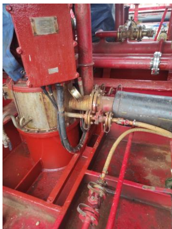
Ilustración 49. Conexión de la línea super stripping a la línea Marpol. Fuente: Trabajo de campo.
