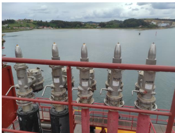
Ilustración 25. Válvulas PV torreta de popa. Fuente: Trabajo de campo.
