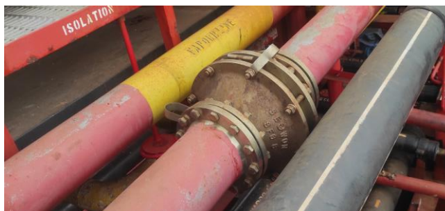
Ilustración 27. Supresor de llamas de detonación de la línea del VECS. Fuente: Trabajo de campo.
