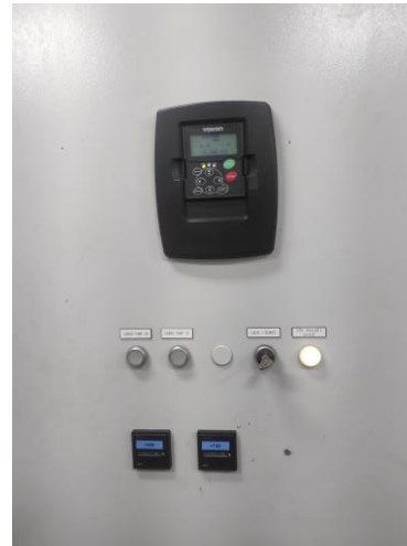
Ilustración 16. Control local del convertidor. Fuente: Trabajo de campo.
