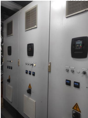
Ilustración 15. Local Convertidores de bombas de carga. Fuente: Trabajo de campo.
