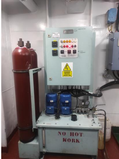
Ilustración 8. Unidad de aceite hidráulico. Fuente: Trabajo de campo.
