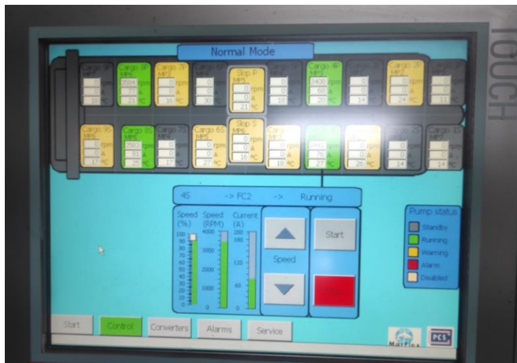
Ilustración 35. Pantalla táctil HMI de las bombas de carga. Fuente: Trabajo de campo.
