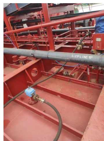
Ilustración 43. Manguera de conexión Cañón - Línea de limpieza. Fuente: Trabajo de campo.
