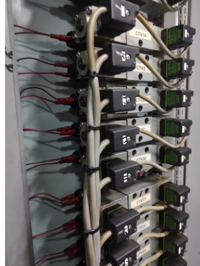
Ilustración 9. Válvulas de solenoide. Fuente: trabajo de campo.
