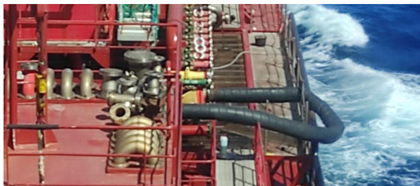
Ilustración 54. Ventilación de los tanques de carga a través del colector. Fuente: Trabajo de campo.
