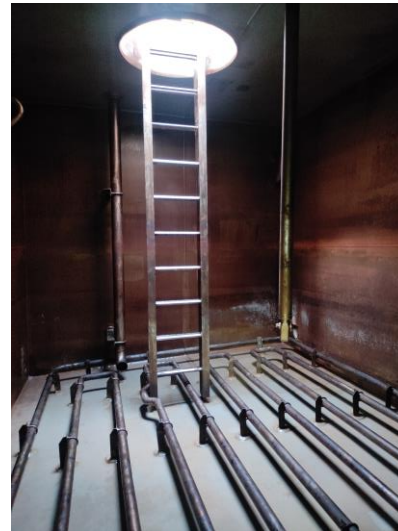
Ilustración 12. Tanque de decantación, Slop. Fuente: Trabajo de campo.
