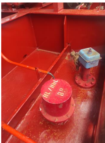
Ilustración 23. Alarma de altos niveles. Fuente: Trabajo de campo.
