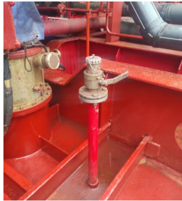
Ilustración 24. Vapour Lock. Fuente: Trabajo de campo.
