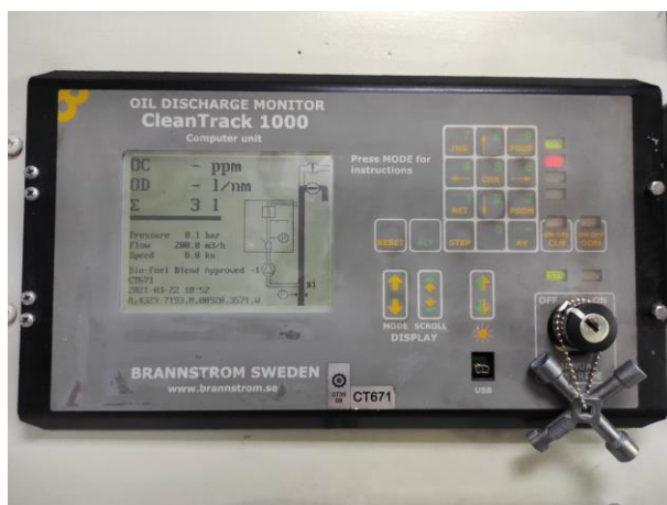
Ilustración 52. Equipo ODME. Fuente: Trabajo de campo.
