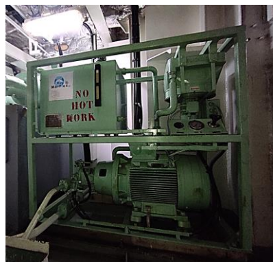
Ilustración 18. Power pack de la bomba de emergencia. Fuente: Trabajo de campo.
