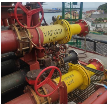
Ilustración 26. Manifolds de la línea de retorno de gases. Fuente: Trabajo de campo.
