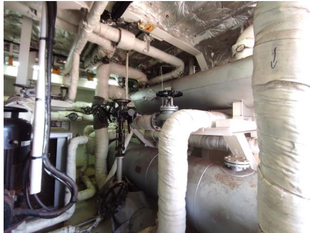
Ilustración 45. Calentador de agua de la línea de limpieza. Fuente: Trabajo de campo.
