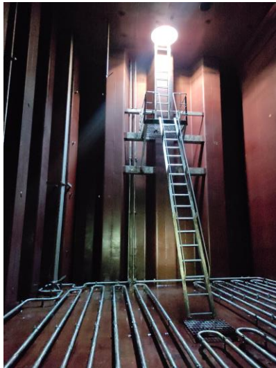
Ilustración 11. Tanque de carga. Fuente: Trabajo de campo.
