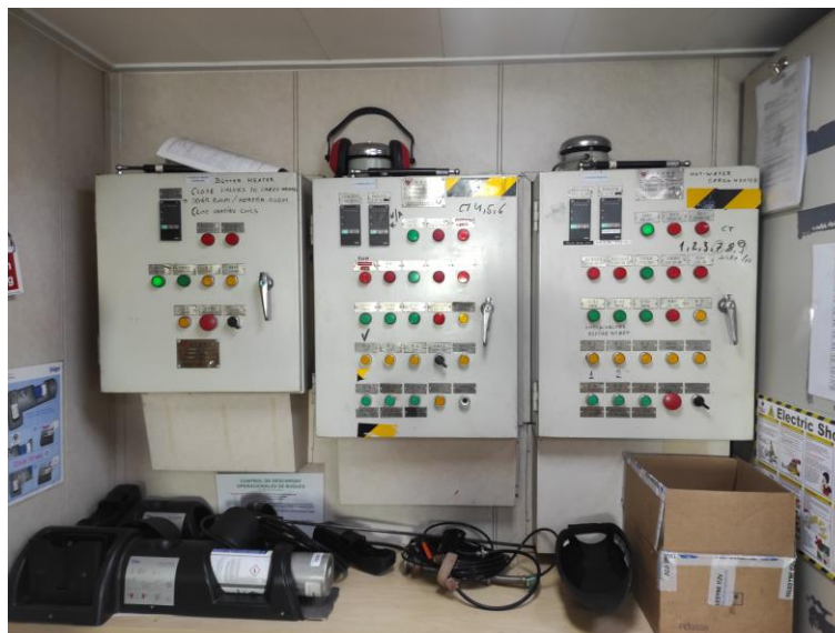
Ilustración 38. Paneles de calefacción. Fuente: Trabajo de campo.
