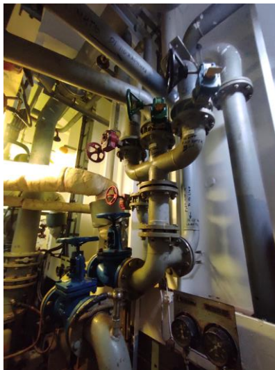
Ilustración 44. Tridente en el cuarto de bombas. Fuente: Trabajo de campo.
