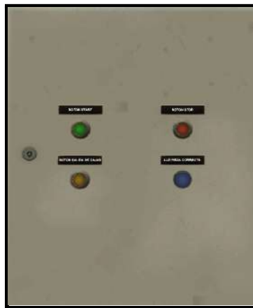
Figura 45.- Panel de mando de la estación 0
