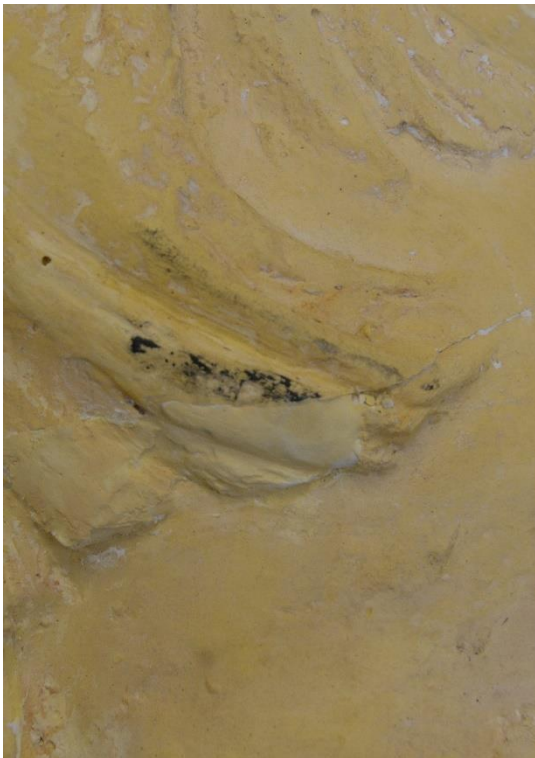
Ilustración 14. Detalle de zona manchada.
