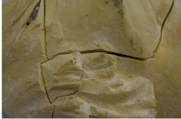
Ilustración 62. Partes fracturadas sin separación completa que causan la aparición de grietas.
