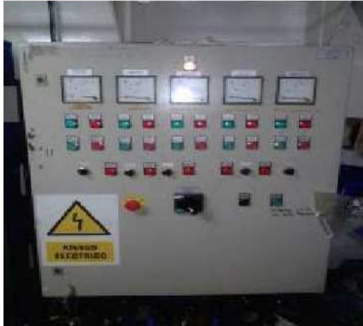
Ilustración 12: Arrancadores Bombas hidráulicas manuales. Fuente: Elaboración propia.
