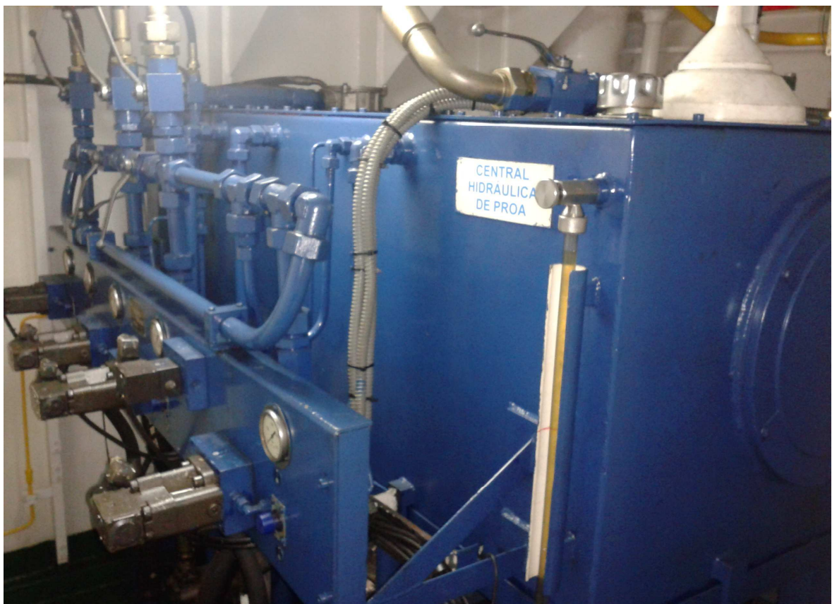
Ilustración 16: Central Hidráulica de Proa. Fuente: Elaboración propia.
