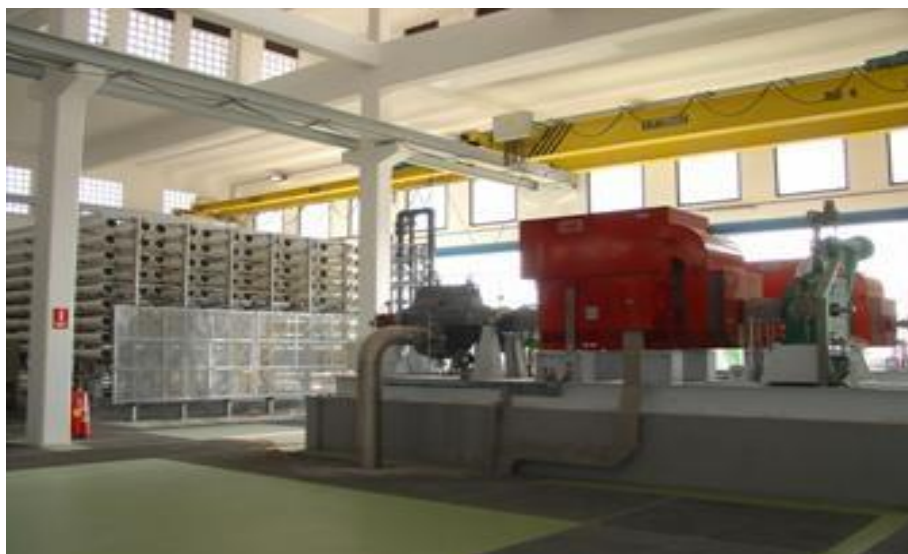
Ilustración 18. Bastidor y grupo de alta presión
