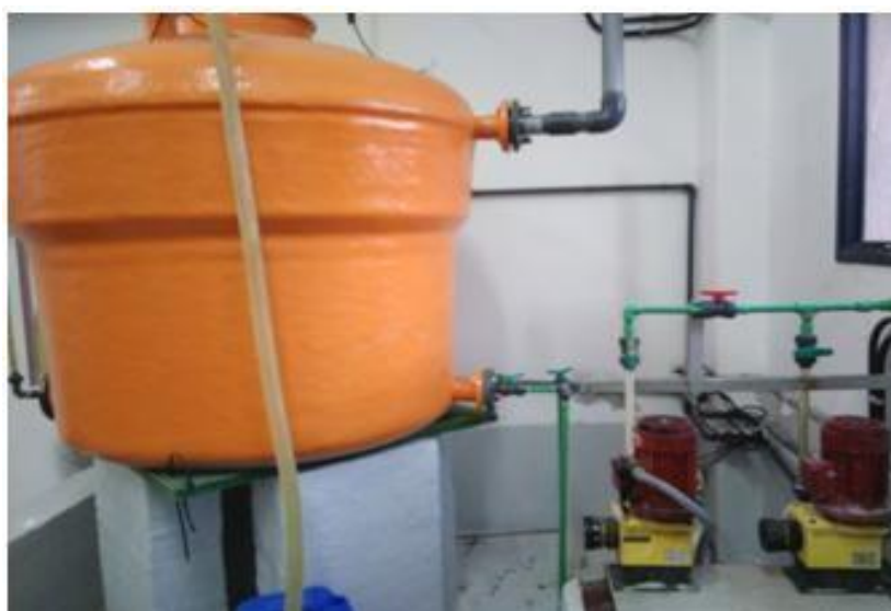
Ilustración 25. Depósito y bombas dosificadoras de hipoclorito
