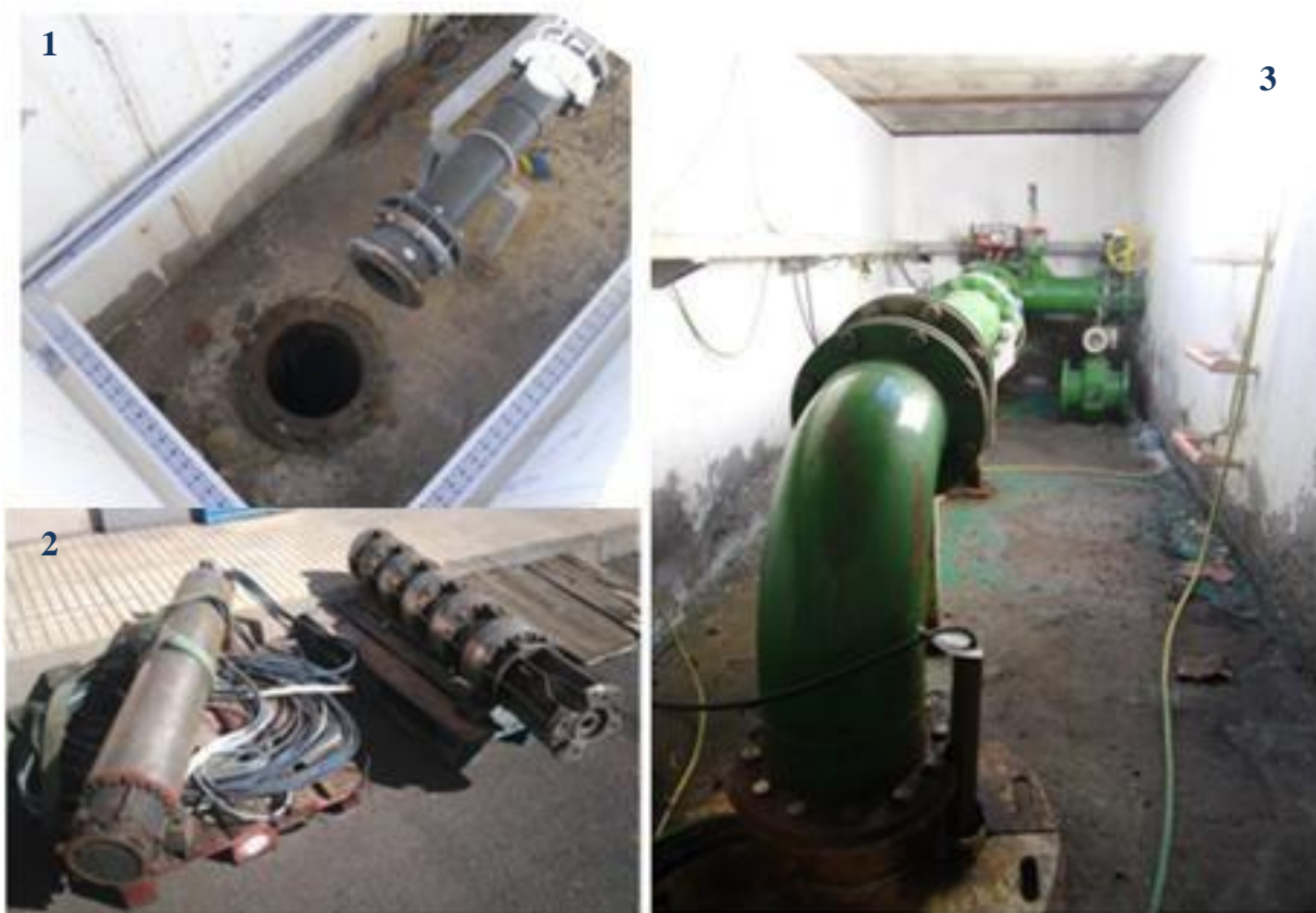
Ilustración 11. Pozo costero (1), motor y bomba de mar (2), y tuberías de impulsión (3)
