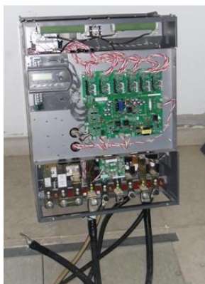
Ilustración 141: Variador de frecuencia que se va a probar
