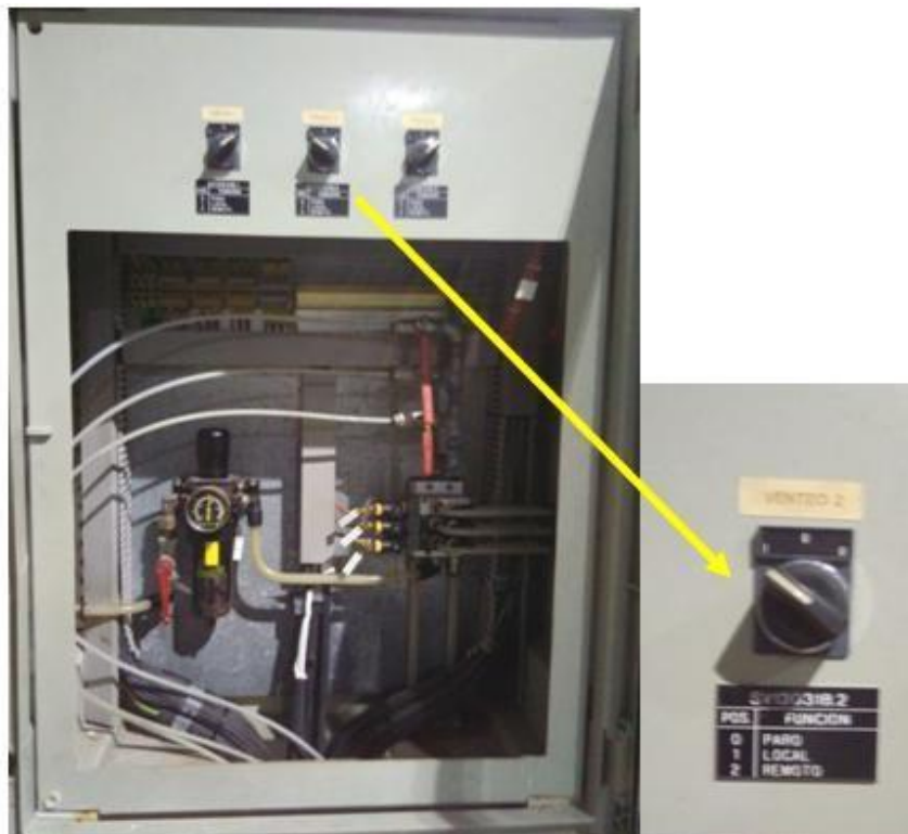
Ilustración 32. Cuadro de electroválvulas para el venteo
