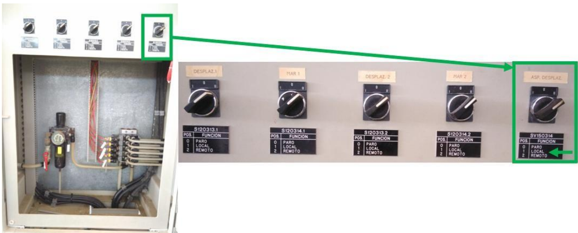
Ilustración 43. Cuadro de electroválvulas
