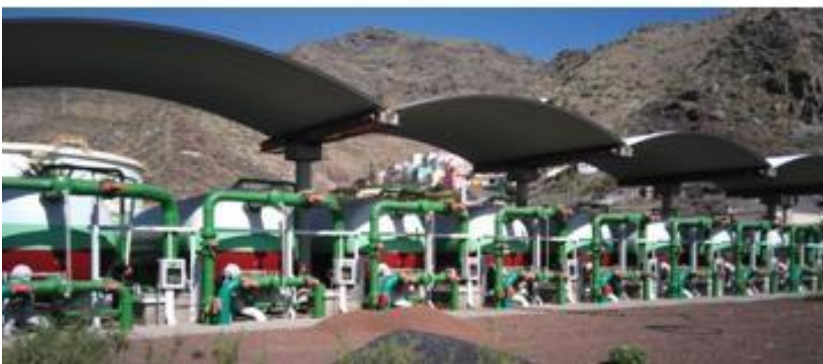
Ilustración 12. Filtro de Arena 1ª etapa
