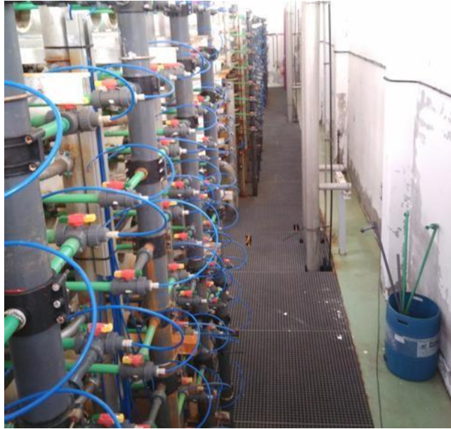
Ilustración 69: Vista trasera de un bastidor, zona de baja presión
