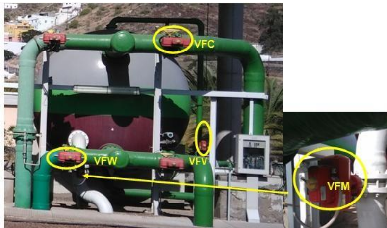
Ilustración 61: Vista frontal y válvulas que actúan en un filtro de arena de 2º etapa
