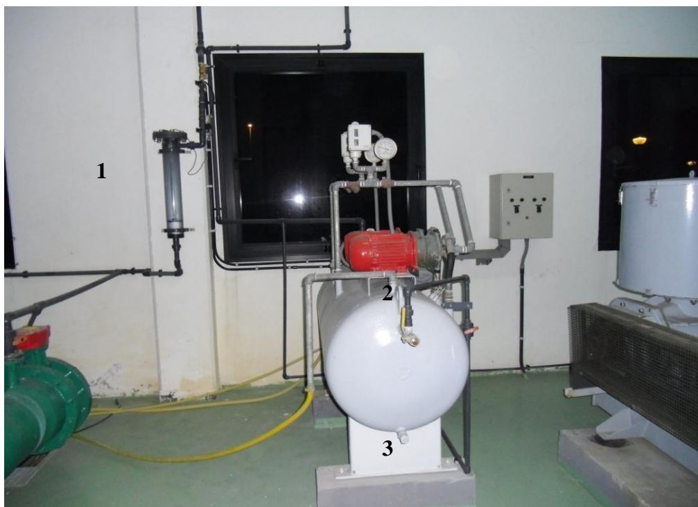
Ilustración 49: Visor (1), bombas de vacío (2) y tanque de vacío (3)
