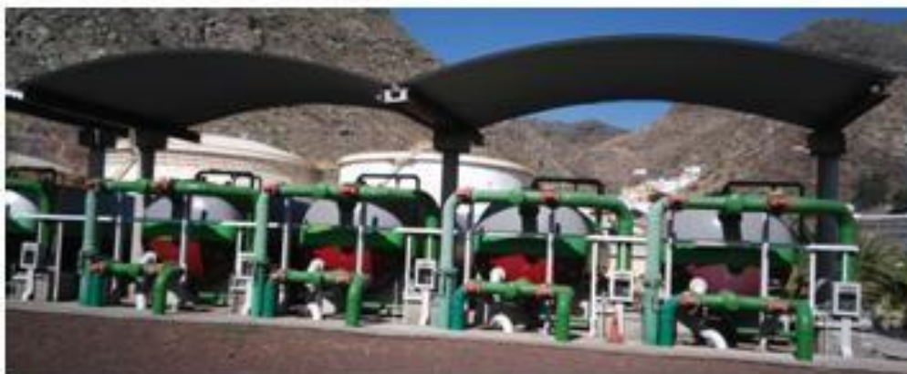
Ilustración 13. Filtro de arena 2ª Etapa
