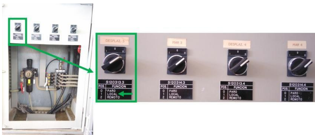
Ilustración 41. Cuadro de electroválvulas
