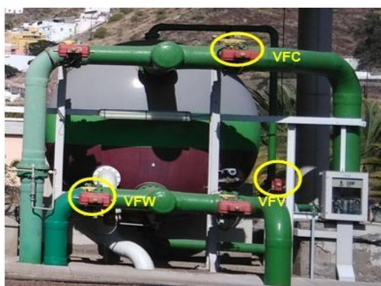
Ilustración 63: Vista frontal y válvulas que actúan en un filtro de arena de 2º etapa
