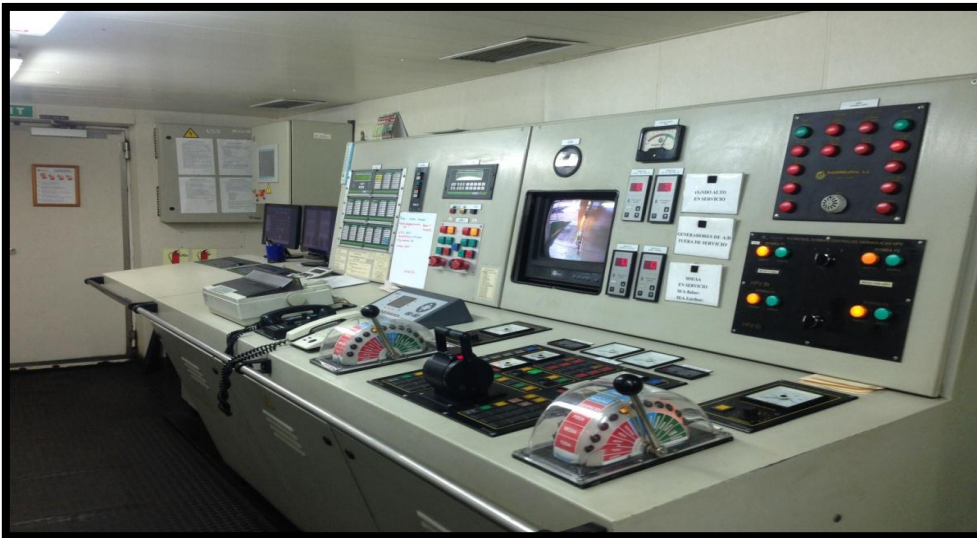
Imagen 16: Control de sala de máquinas.
