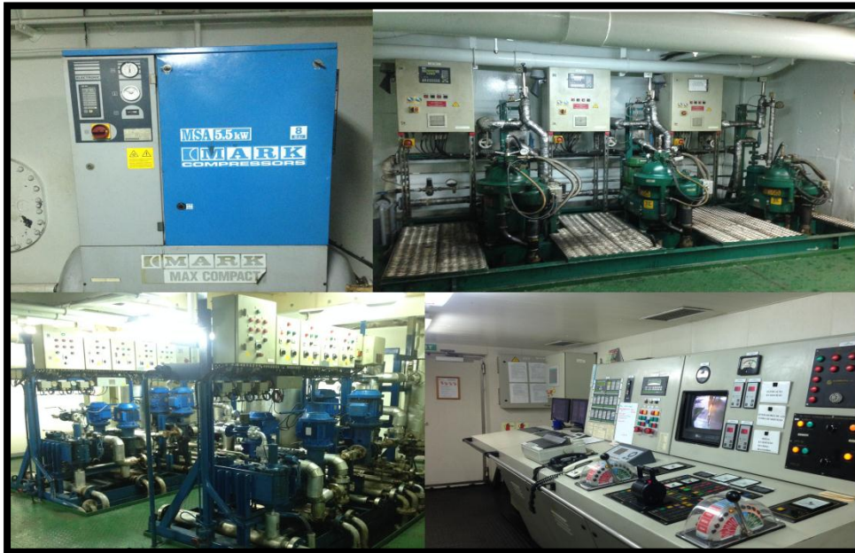
Imagen 13: Compresor, modulo combustible, modulo depuradoras y panel de control S/M.
