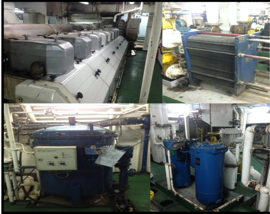
Imagen 14: M/P, separador de sentina, enfriador de placas y filtro doble.
