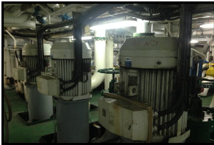
Imagen 67: Bombas refrigeración agua salada MM.PP
