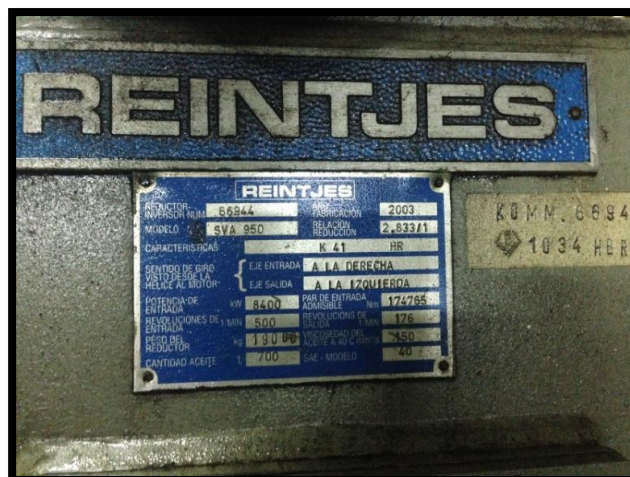
Imagen 50: Placa identificativa de la reductora.
