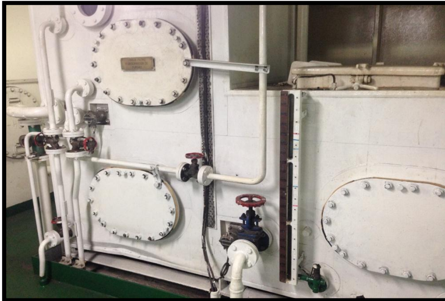
Imagen 28: Tanque observación de purgas.
