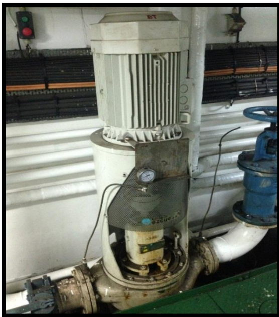
Imagen 76: Bomba refrigeración A/D B/T.
