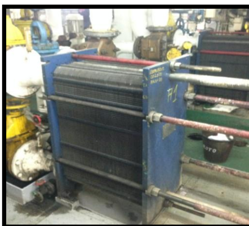
Imagen 54: Enfriador de placas.
