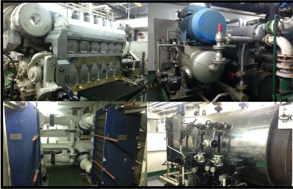
Imagen 12: M/A; caldera, equipo aire acondicionado y enfriadores centrales A/D
