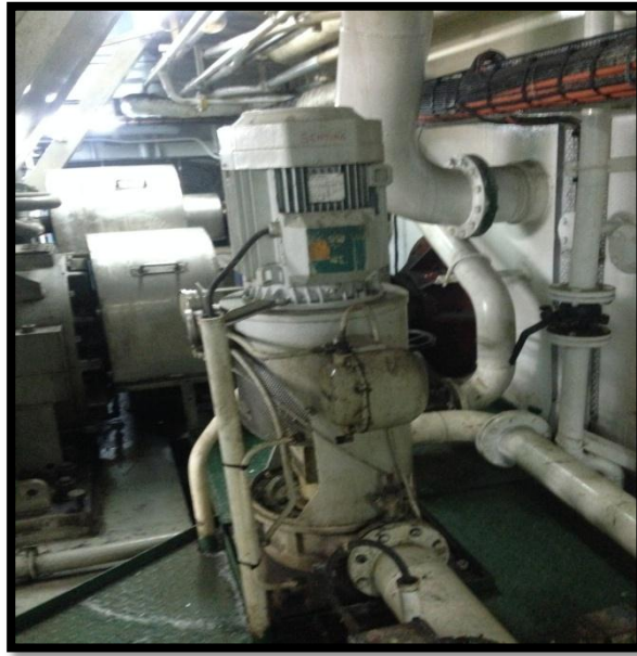
Imagen 58: Bomba centrífuga de sentina
