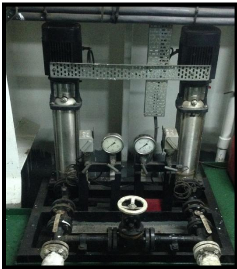
Imagen 84: Bombas circulación agua economizador.
