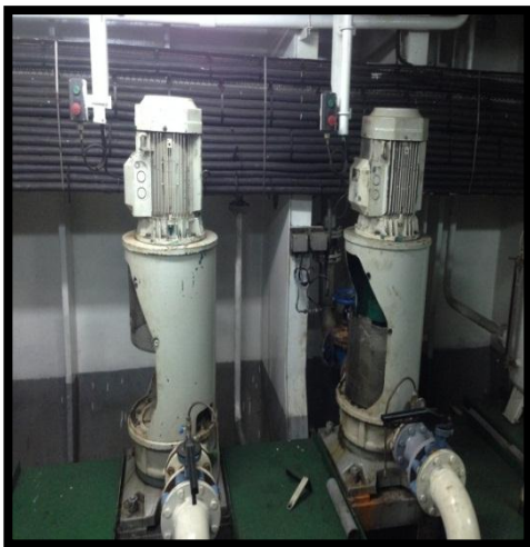
Imagen 81: Bombas A/S del condensador de vapor sobrante.
