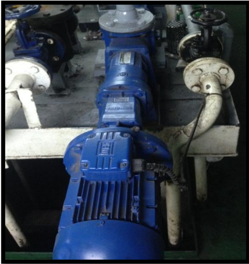
Imagen 72: Bomba De lodos
