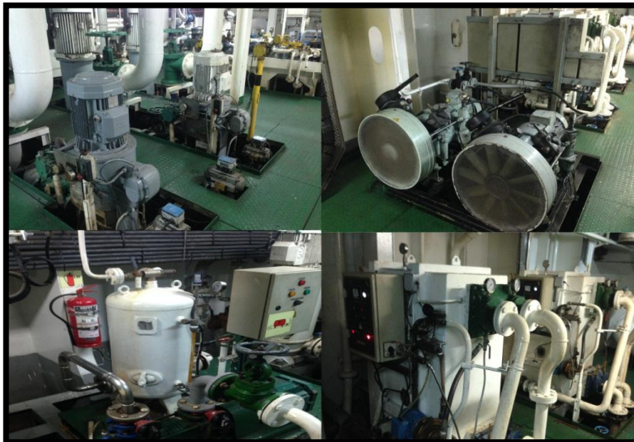
Imagen 15: bombas de lastre, compresores, grupo de presión y generadores de agua dulce.
