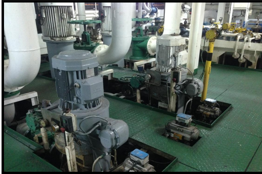
Imagen 66: Bombas de lastre.
