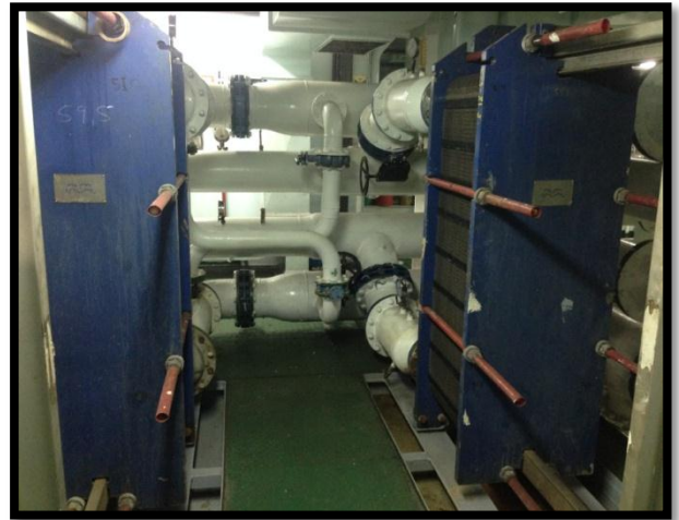
Imagen 30: Enfriador de agua dulce
