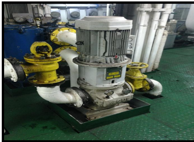
Imagen 62: Bomba de pre-lubricación de los motores principales
