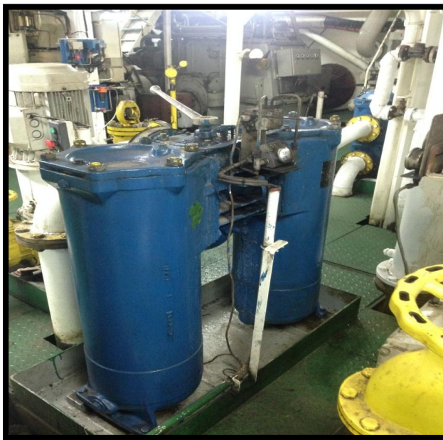
Imagen 61: Filtro de seguridad
