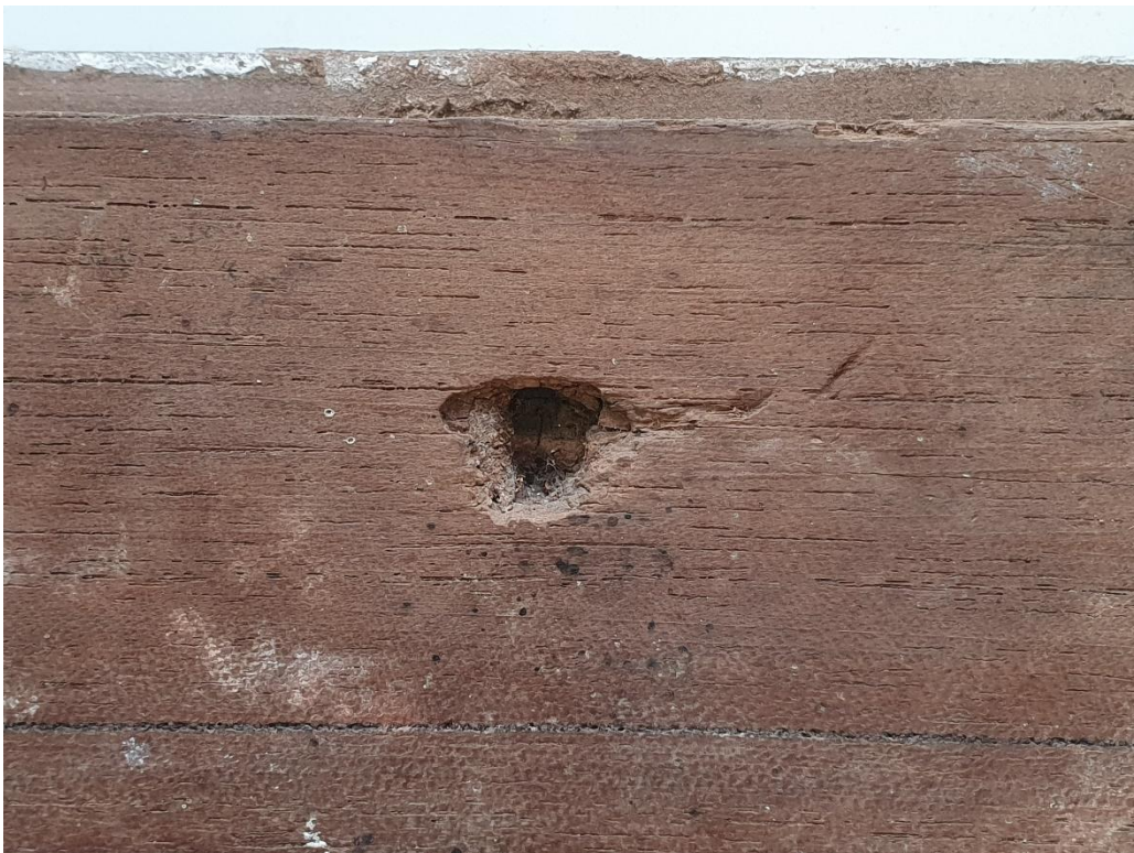
Ilustración 74.- Nudo desprendido de la parte inferior a la mitad del larguero.
