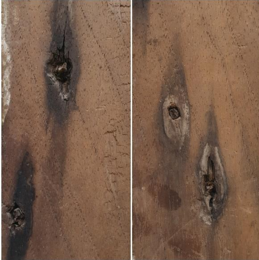
Ilustración 73.- Detalle de los nudos desprendidos.
