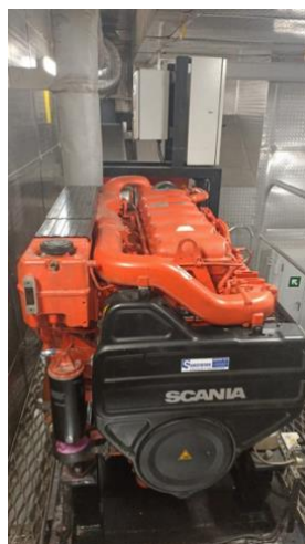
Ilustración 100: Motor Auxiliar. Fuente: Fotos cedidas al autor.
