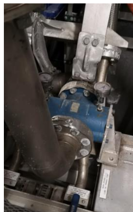
Ilustración 94: Bomba Pre-lubricación. Fuente: Trabajo de Campo.
