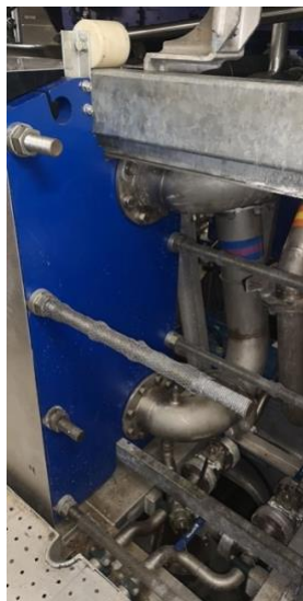
Ilustración 91: Enfriador de placas. Fuente: Trabajo de Campo.
