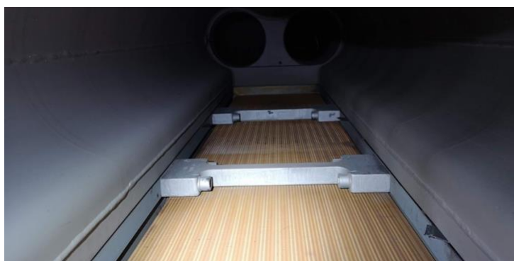
Ilustración 91: Enfriador Aire de Barrido. Fuente: Trabajo de Campo.
