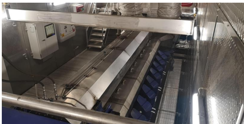
Ilustración 90: Sala de Máquinas. Fuente: Trabajo de Campo.
