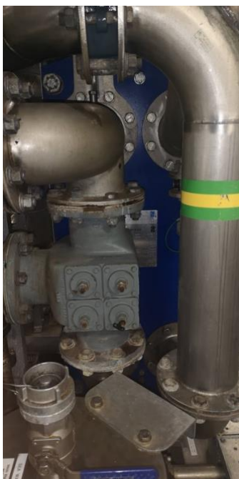
Ilustración 92: Termostáticas de Agua de Baja. Fuente: Trabajo de Campo.
