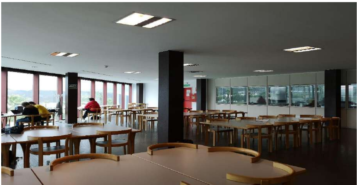
Figura 37. Deficiencias en pantallas de tubos fluorescentes. Vista general.
