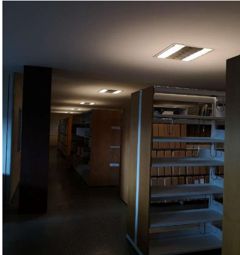
Figura 39. Deficiencias en pantallas de tubos fluorescentes. Depósito de libros.
