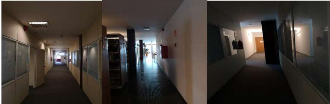
Figura 38. Deficiencias en pantallas de tubos fluorescentes. Pasillo.
