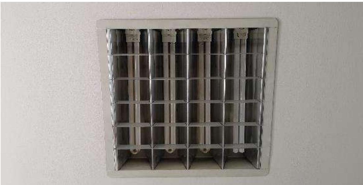
Figura 27. Pantalla de 60x60 cm con 4 lámparas fluorescentes. Estado actual de la instalación
