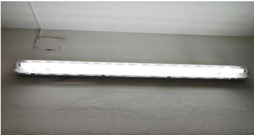
Figura 33. Lámparas fluorescentes RADIUM NL-T8 36W/840/G13 como aplique en pared. Vista detallada.
