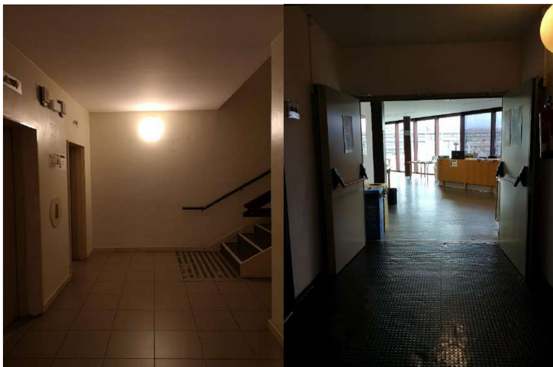
Figura 40. Deficiencias en pantallas de tubos fluorescentes. Salida del vestíbulo y acceso a planta.
