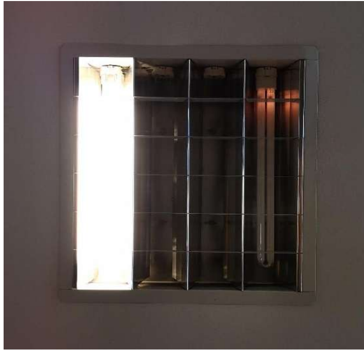
Figura 36. Deficiencias en pantallas de tubos fluorescentes. Vista detallada.
