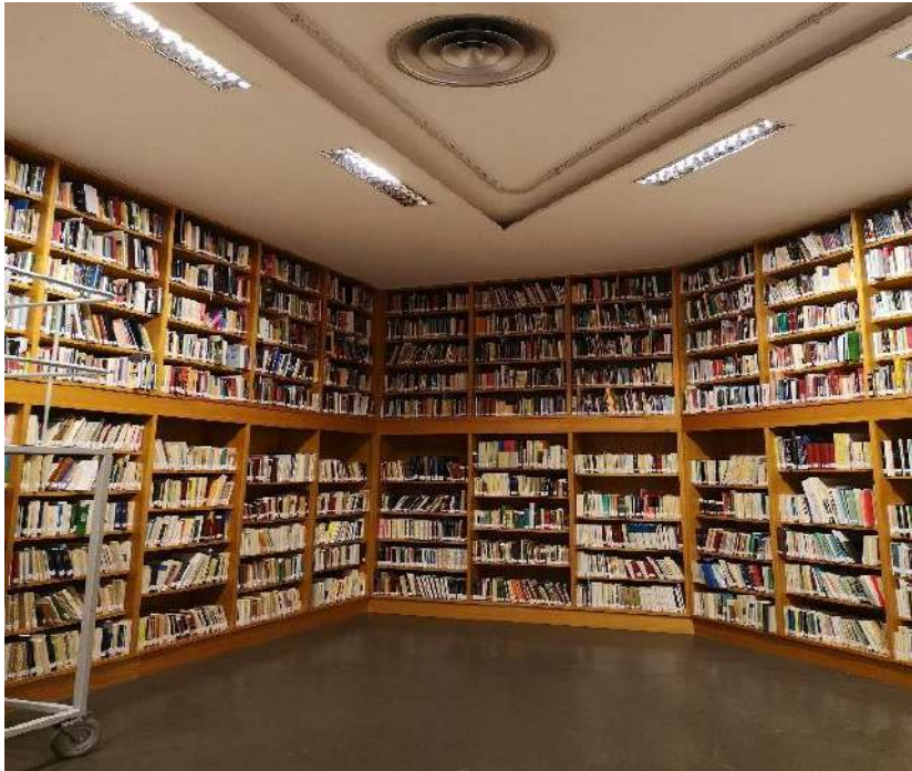
Figura 35. Luminarias PHILIPS MASTER PL-L 36W/830/4P 1CT/25 en Biblioteca de Canarias.
