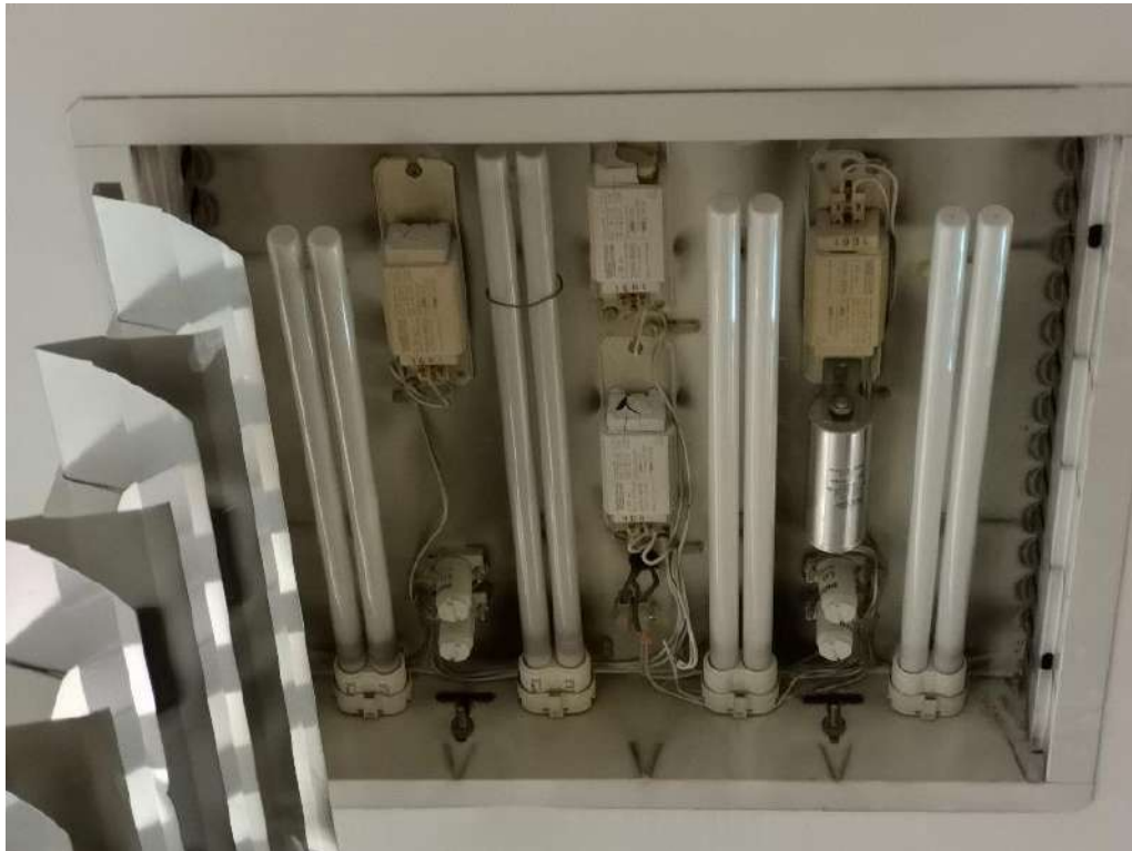
Figura 41. Equipos auxiliares. Vista interior. Pantalla fluorescente.
